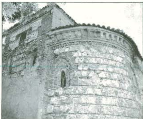
Abside de la Iglesia de S. Martín Obispo, de estilo gótico mudéjar de mampostería, restaurada en su totalidad por la Diputación, y declarada recientemente Monumento Nacional.
