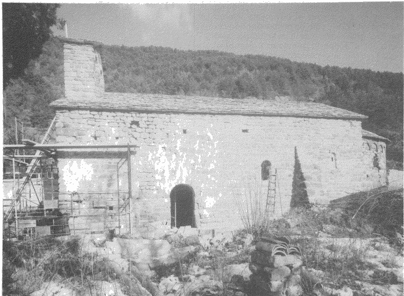
Lámina I.—A) Vista desde el sur de la iglesia de Sant Vicenç de Rus, durante las actuales obras de restauración (enero 1987).
