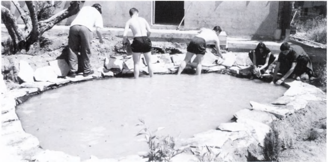
Llenado del estanque y sujeción de la lámina flexible a los bordes.
