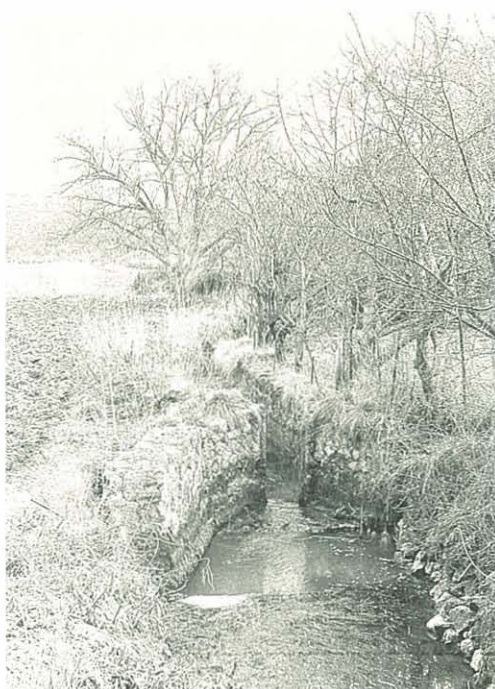
Infraestructura de regadío en la vega del Tajuña. Cacera invadida por la maleza.
