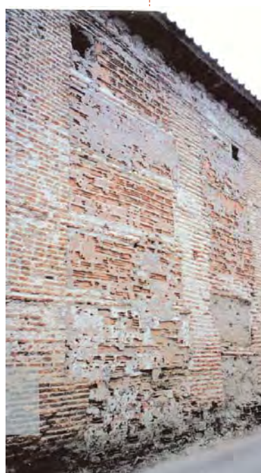
Estado de las fachadas antes de la restauración.
