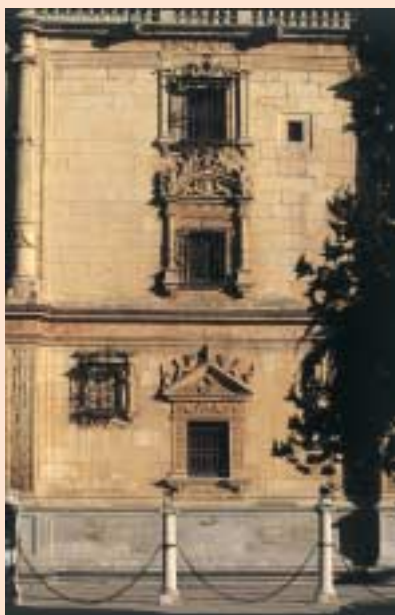
■ Detalle del alzado de la fachada de la Universidad de Alcalá con las cadenas que la preceden, forjadas en 1561.
