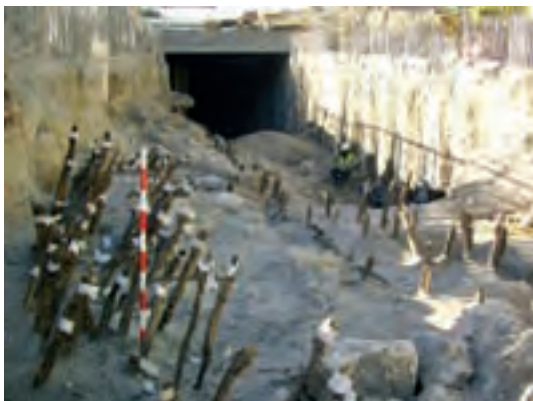
Figura 24. By-pass sur: vista general del hallazgo realizado en la rampa de acceso al Pozo de Ataque de la tuneladora del By-Pass Sur.
