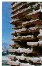
Efecto de la erosión en las fábricas de ladrillo de las murallas. (Archivo Dirección General de Patrimonio Histórico)
