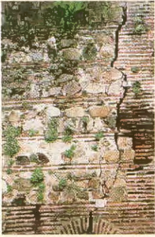
Grietas y fábricas deterioradas en una de las torres. (Foto: GEOCISA. Geotecnia y Cimientos S.A.)
