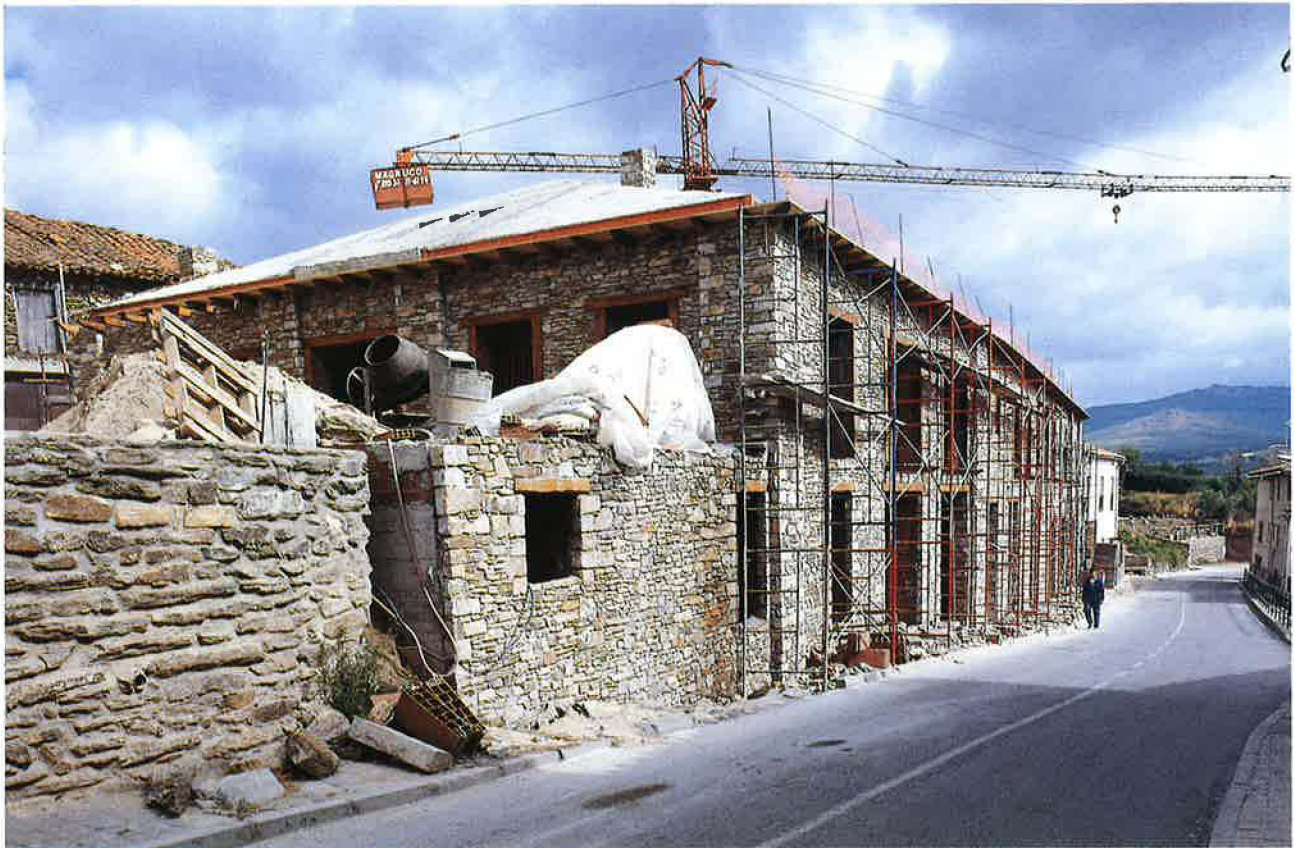
Centro de Servicios Polivalentes. Construido por la Dirección General de Empleo de la CAM, albergará locales comerciales, alojamientos turísticos y centro de la tercera edad.
