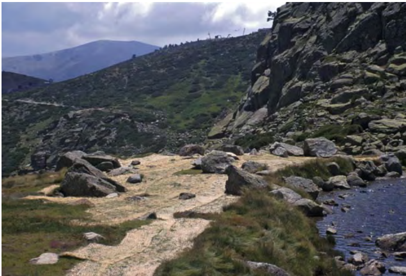
Foto 21. Mantas vegetales para proteger al suelo de la erosión y ayudar a la recolonización vegetal mediante la germinación de semillas.
