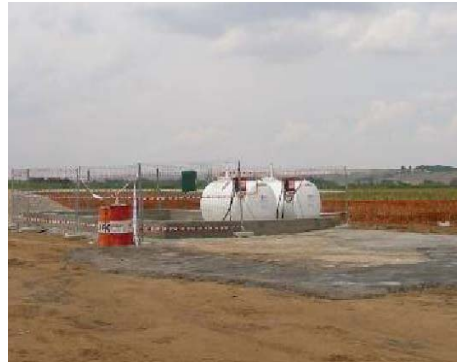
Figura 83. Depósitos de combustibles ubicados en una zona correctamente acondicionada.
