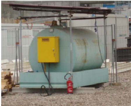
Figura 82. Depósito de combustible dotado de una bandeja de recogida para derrames.
