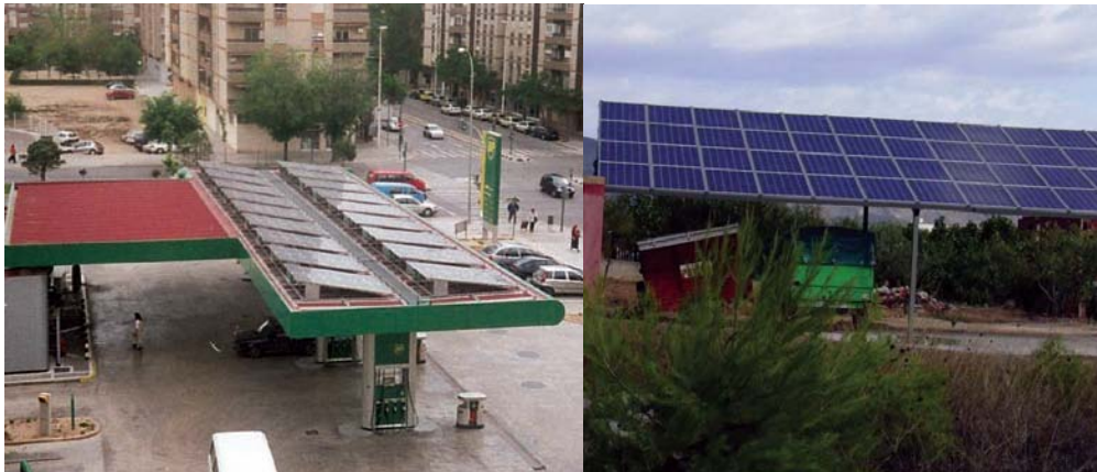
Figura 29. Ejemplos de instalaciones solares fotovoltaicas
