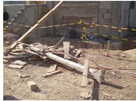
Figura 70. Madera y otros residuos depositados en una zona sin delimitar ni identificar.
