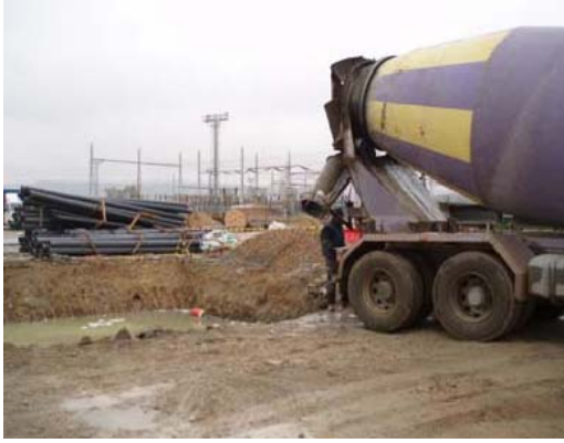
Figura 84. Vehículo hormigonera limpiando su cubo en una balsa sin acondicionar
