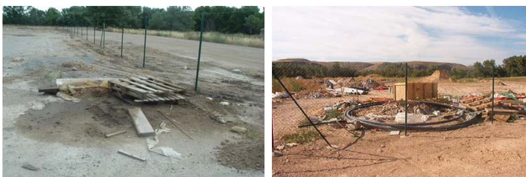
Figura 62. Imágenes de una incorrecta gestión de residuos en obra, residuos depositados directamente sobre el suelo
