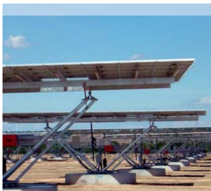
Figura 28. Paneles fotovoltaicos con seguidor
