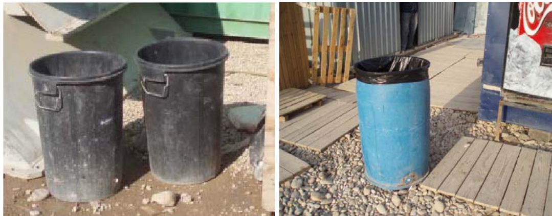
Figura 66. Contenedores sin identificar repartidos por la zona de obras
