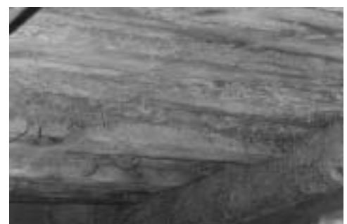
Sala del reloj. Forjado atacado por xilófagos.
