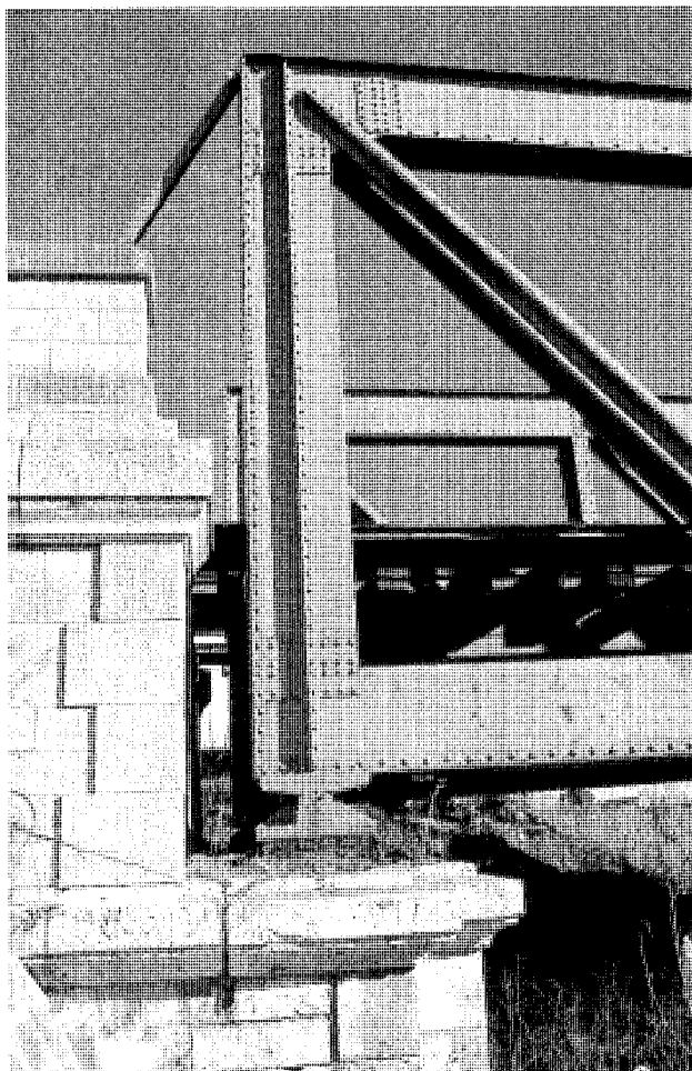
Puente sobre el Tajo. Detalle de apoyo sobre estribo. Foto Actividades y Servicios Fotográficos , 2003.
