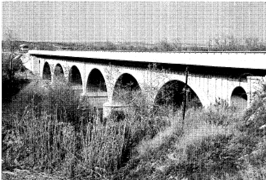
Vista general del puente sobre el río Tajo entre Aranjuez-Castillejo y Añover de Tajo. Foto Actividades y Servicios Fotográficos, 2003.
