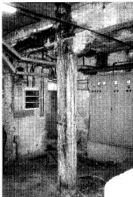
Pie derecho y zapata de madera en el antiguo molino de la fábrica de papel. Foto Alberto Sanz.
