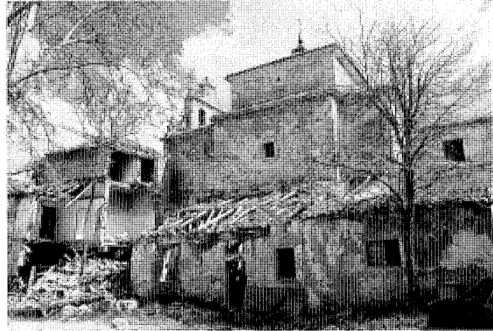
Ruina progresiva de las edificaciones auxiliares. Foto M. Lasso de la Vega.
