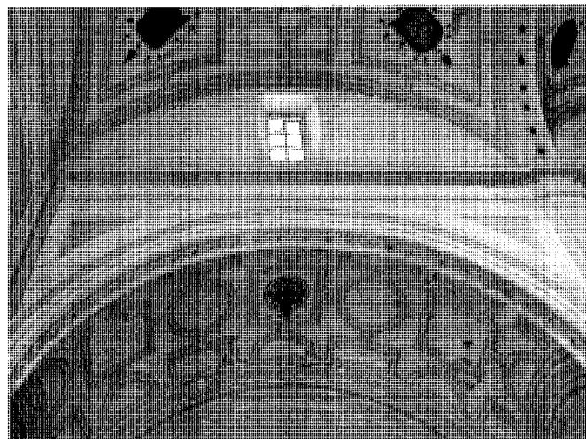
Detalle de la transición interior de cubiertas entre la nave central y una de las naves laterales. Foto, Félix Cabrero, 2005.
