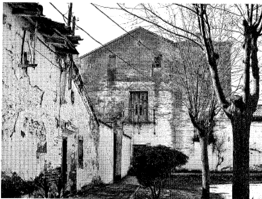
La “casa grande”, antigua vivienda de los propietarios. Fachada a la Pza. de España. Foto José Ablanedo.
