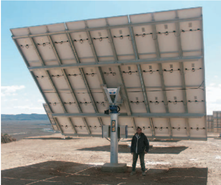
Foto 7. Instalación fotovoltaica sobre seguidor solar.
