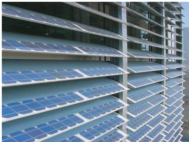
Foto 10. Instalación fotovoltaica integrada en lamas.
