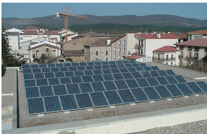
Foto 2. Instalación conectada a red.
