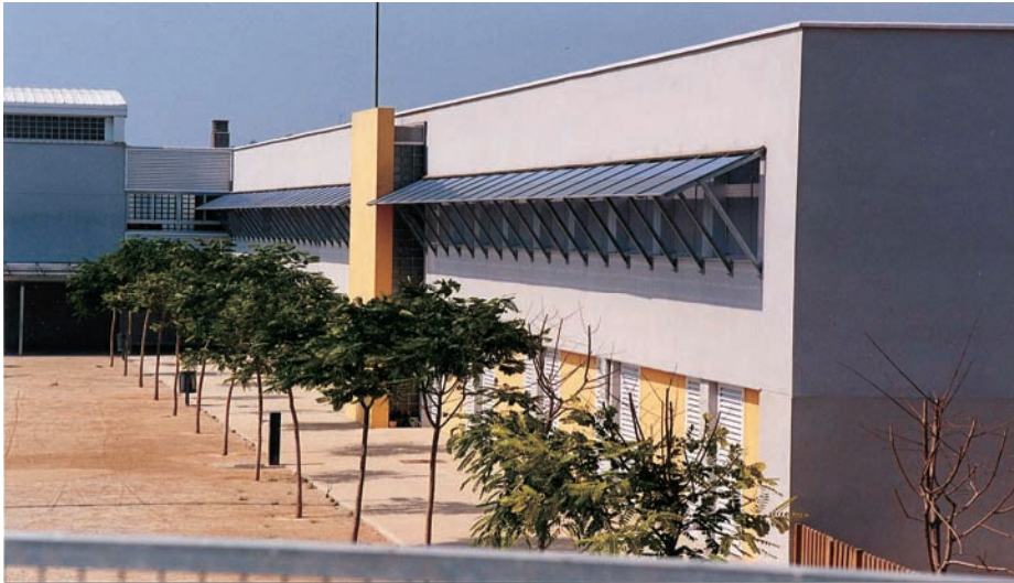
Foto 11. Instalación fotovoltaica integrada en parasoles.
