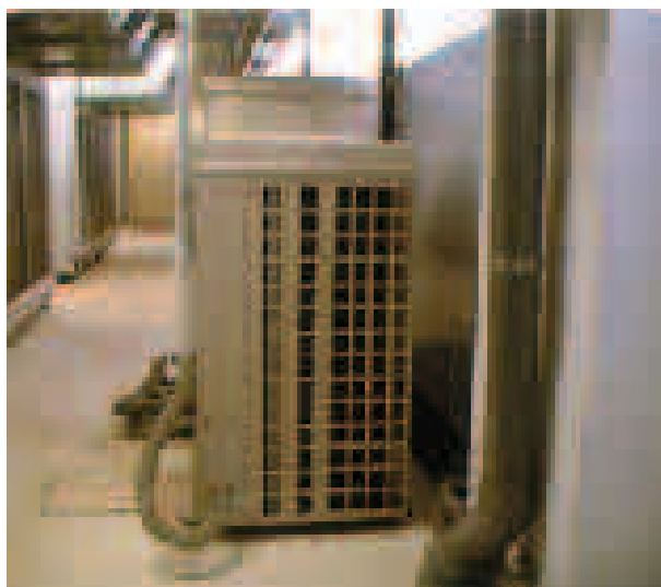
Figura 10. Condensador de un grupo de frío.
