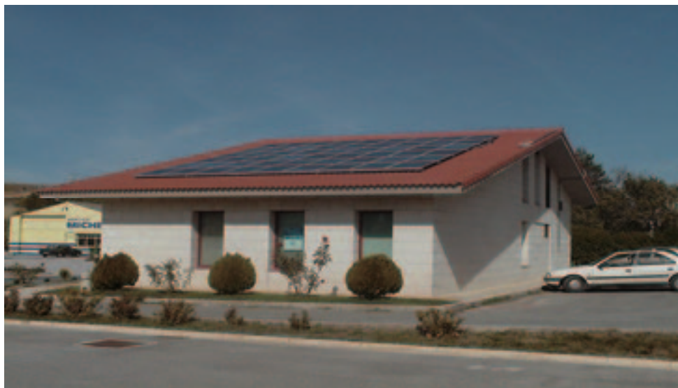
Foto 3. Sistema fotovoltaico sobre tejado inclinado.
