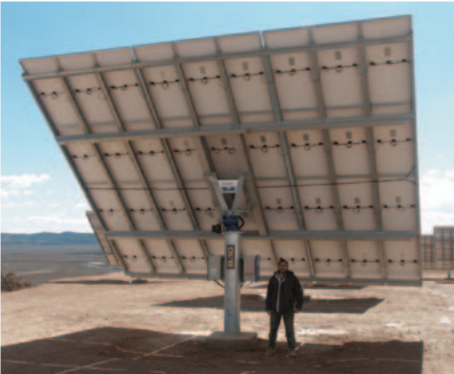
Foto 5. Instalación fotovoltaica sobre seguidor solar.
