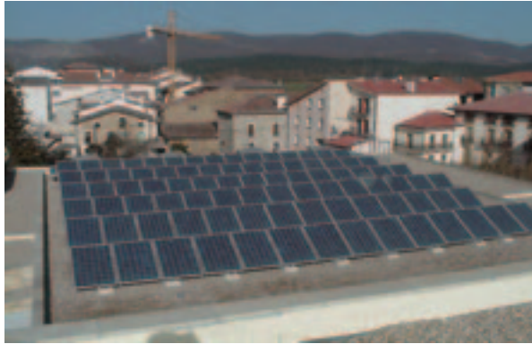
Foto 2. Instalación conectada a red.
