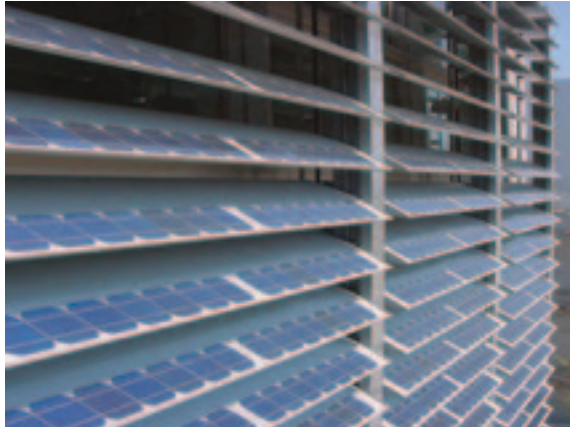
Foto 8. Instalación fotovoltaica integrada en lamas.
