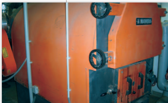
Figura 10: Caldera de biomasa de tamaño medio (250 kW).
