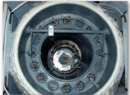
Figura 27: Vista superior del intercambiador de calor.
