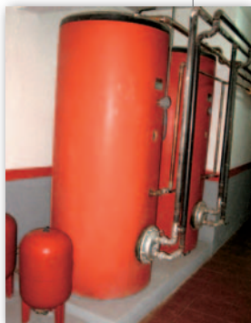
Figura 53: Depósitos de acumulación de ACS.
