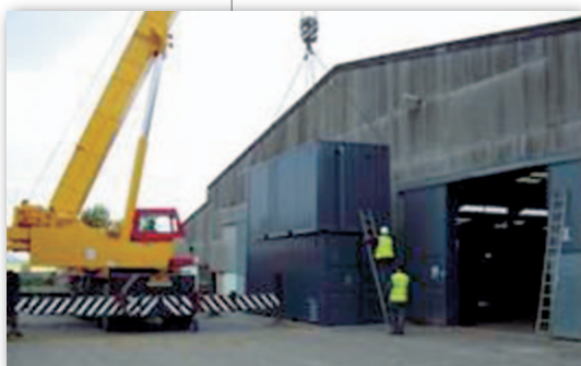
Figura 24: Caldera y almacén de pellets en contenedores.
