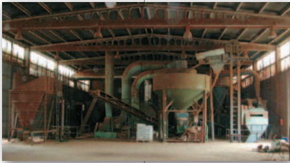
Figura 17: Planta de pelletización (La Coruña)
