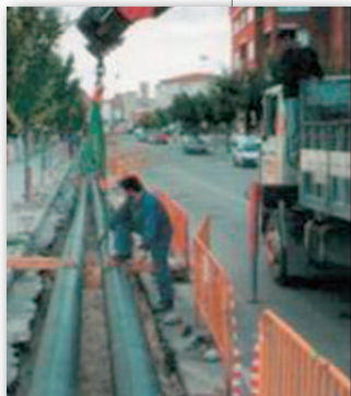
Figura 50: Red de tuberías.
