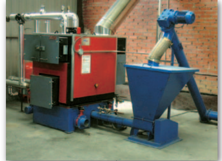
Figura 32: Caldera de pellets (admite otros combustibles) de 250 kW de potencia.
