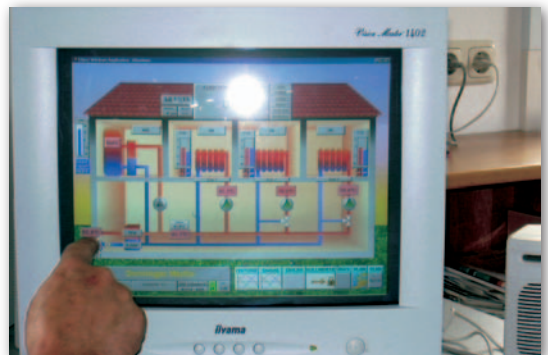
Figura 8: Supervisión del sistema (detalle de vivienda)
