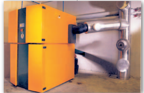
Figura 33: Caldera de pellets de 150 kW.
