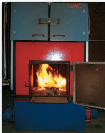
Figura 44: Caldera de biomasa.
