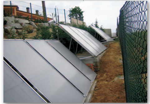
Figura 35: Campo de captadores solares
