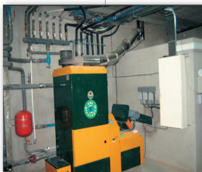
Figura 34: Instalación mixta de biomasa y solar térmica en pabellón de deportes.
