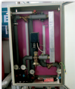
Figura 7: Intercambiador de placas.
