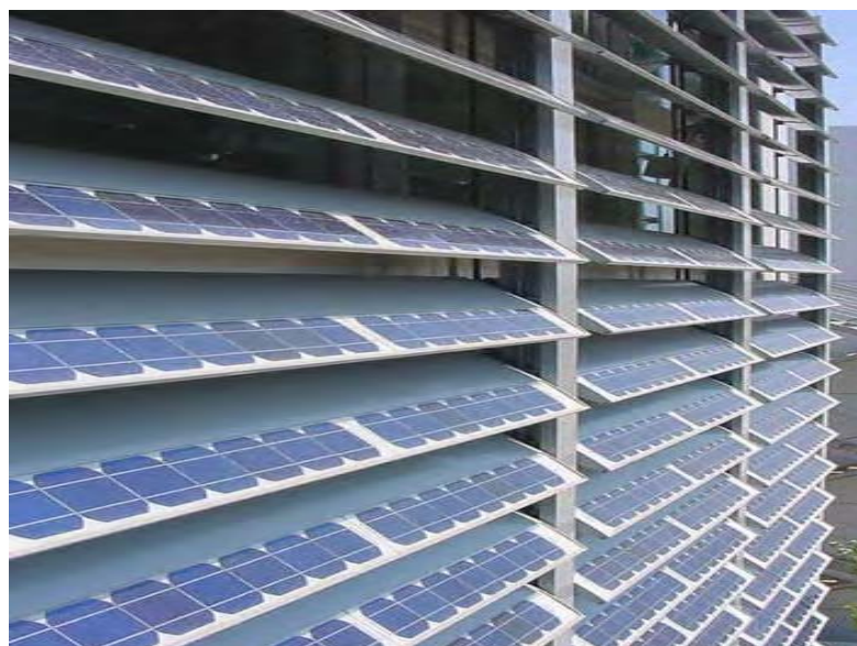
Foto 10. Instalación fotovoltaica integrada en lamas.
