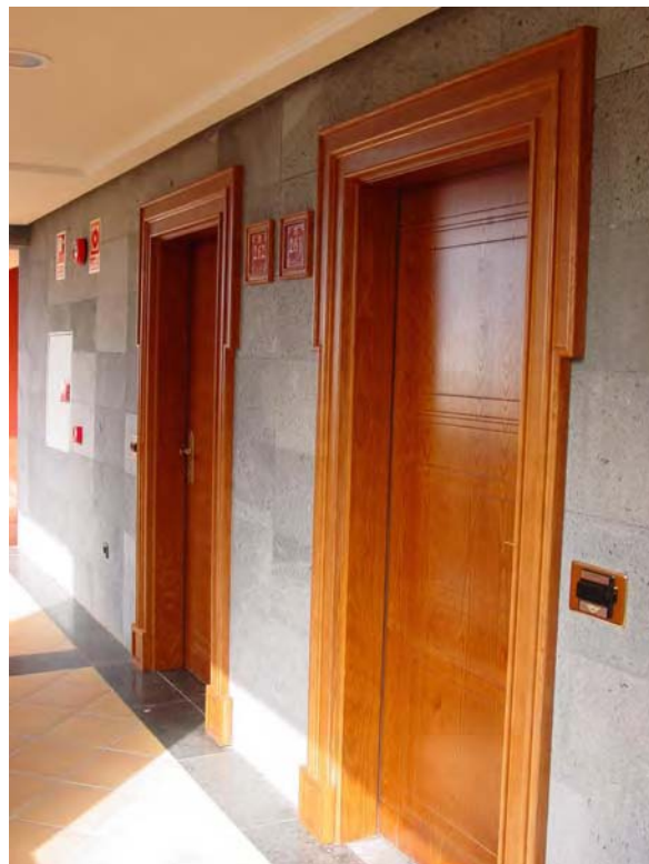
Figura 3. Control de accesos.
