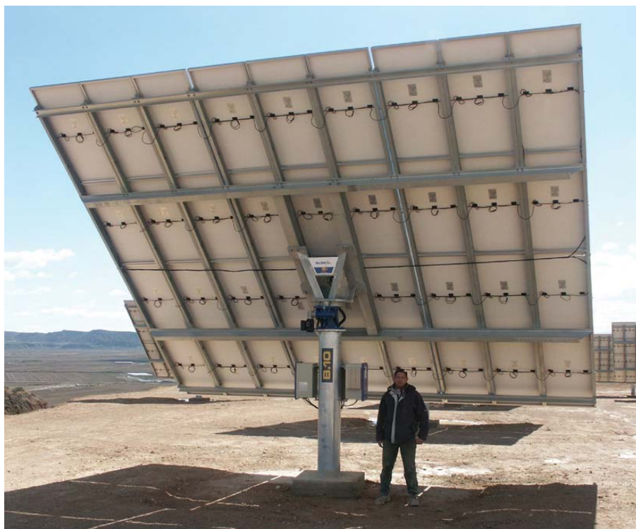
Foto 7. Instalación fotovoltaica sobre seguidor solar.
