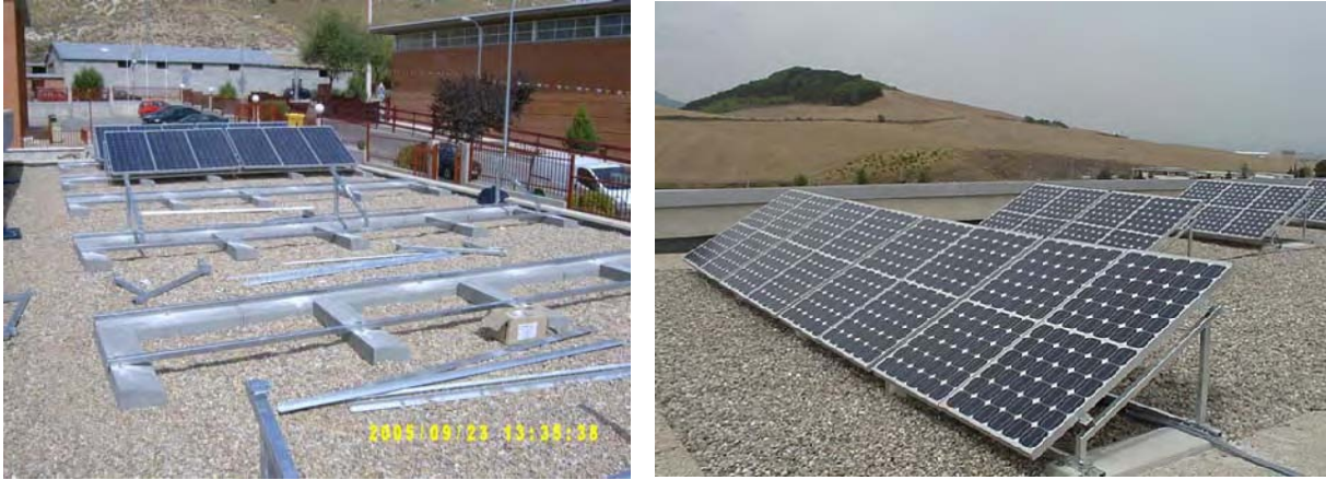
Foto 6. Sistema fotovoltaico sobre tejado plano no perforable.
