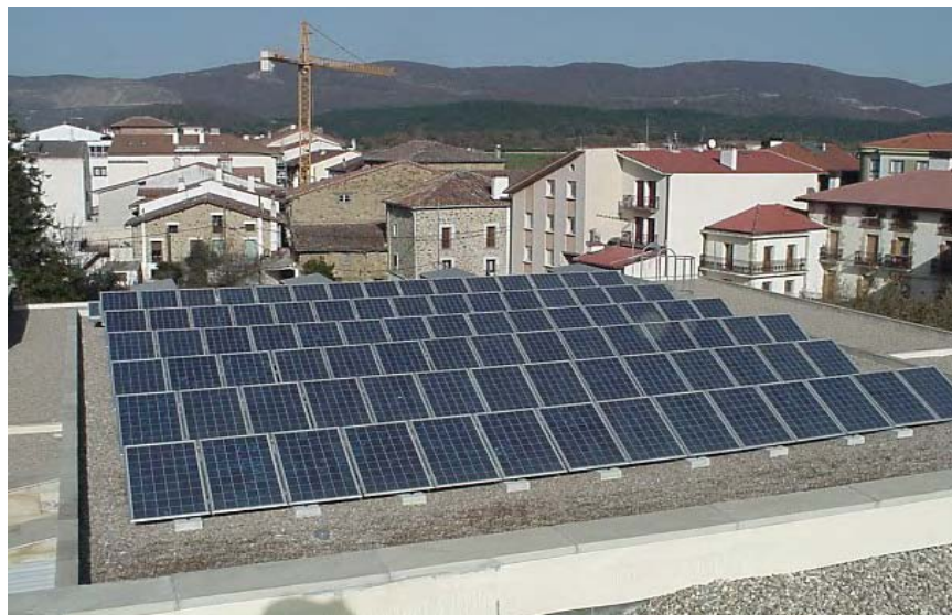
Foto 2. Instalación conectada a red.
