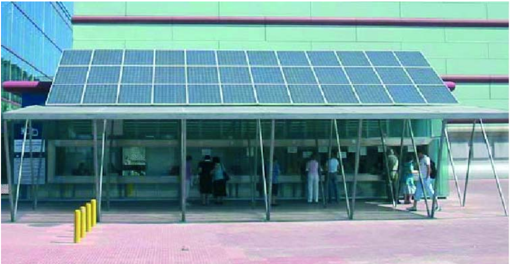
Figura 18. Instalación de energía solar fotovoltaica en IFEMA (Madrid).
