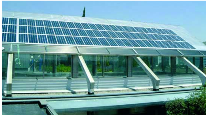
Figura 23. Paneles fotovoltaicos en la sede central de Sanitas (Madrid). Fuente: "Proyectos emblemáticos en el ámbito de la energía". Comunidad de Madrid.
