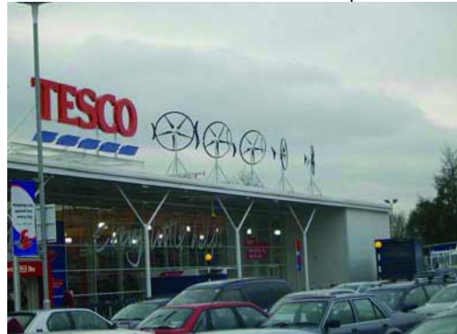
Figura 12. Ejemplo de integración arquitectónica de aerogeneradores. Fuente: www.tescocorporate.com .
