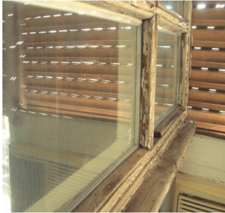
Foto 18. Carpintería madera con doble acristalamiento banal en mal estado de conservación.
