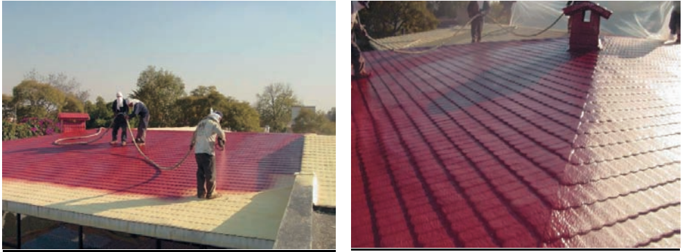
Foto 5. Rehabilitación de la cubierta con proyección de espuma de poliuretano sobre teja o pizarra y proyección con elastómero.
