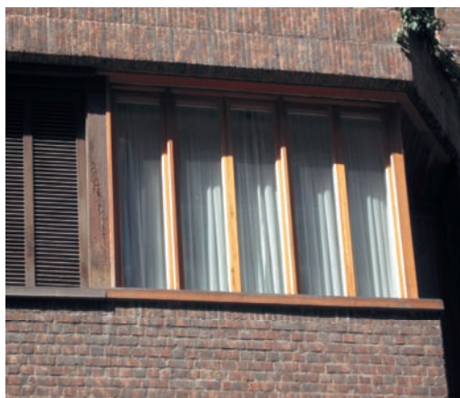
Foto 19. Carpintería de madera con doble acristalamiento banal.
