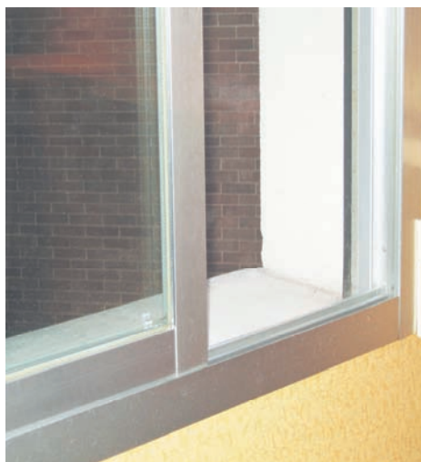
Foto 14. Carpintería metálica de aluminio con doble acristalamiento bandal.
