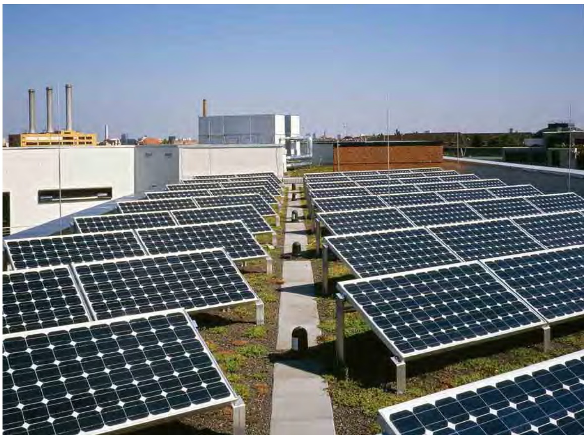
Foto 2. Módulos fotovoltaicos instalados sobre cubierta plana.
