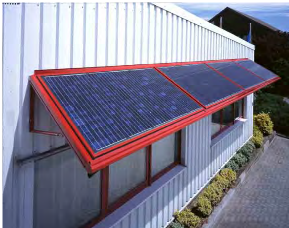
Foto 3. Instalación solar fotovoltaica en voladizo.
