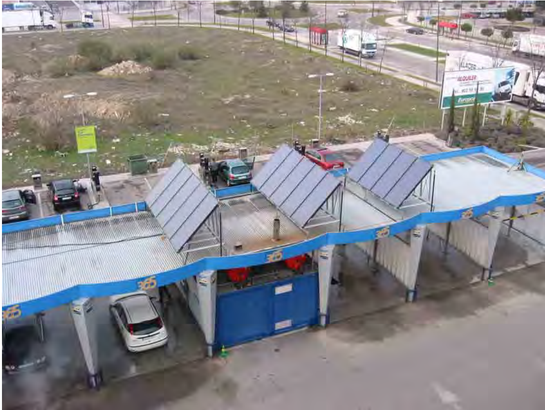
Foto 1. Instalación solar térmica en un centro de lavado.
