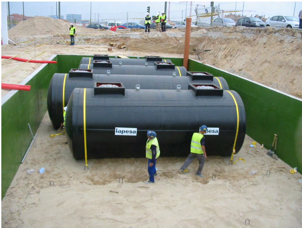
Foto 1. Tanques de almacenamiento.
