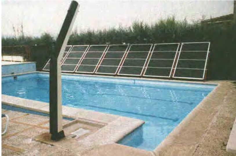
Foto 2. Colectores solares térmicos para piscina.
