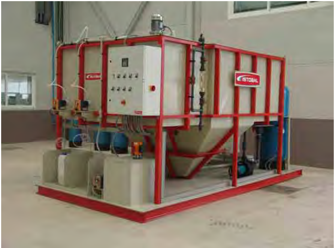
Foto 8. Depuradora físico-química de 5 m 3 /h.
