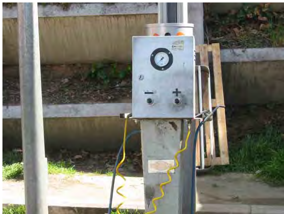
Foto 6. Instalación de aire comprimido.
