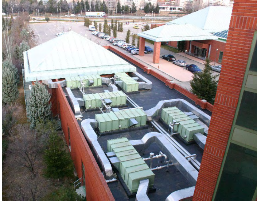
Foto 5. Condensador de un grupo de frío.
