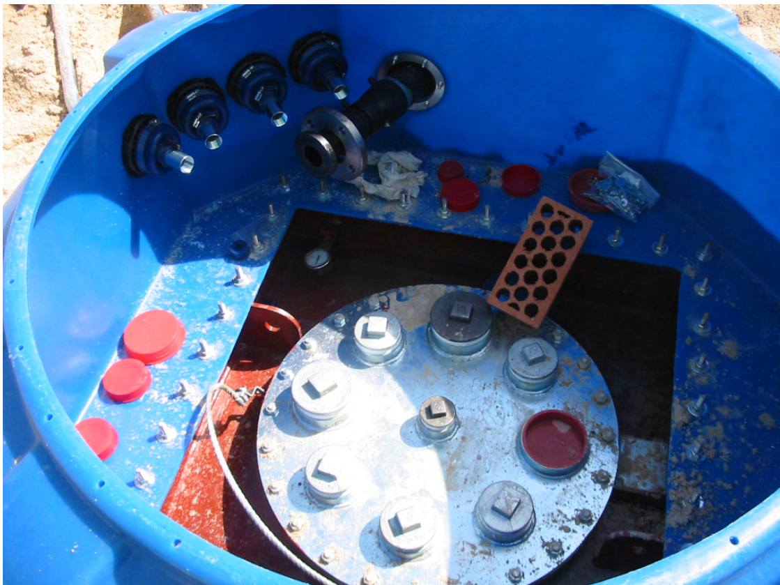
Foto 8. Recuperación de vapores.
