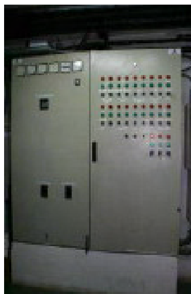
Foto 3. Sistema de control y regulación.
