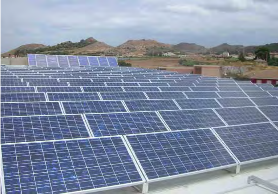
Foto 1. Módulos solares compuestos por células fotovoltaicas sobre cubierta de chapa.
