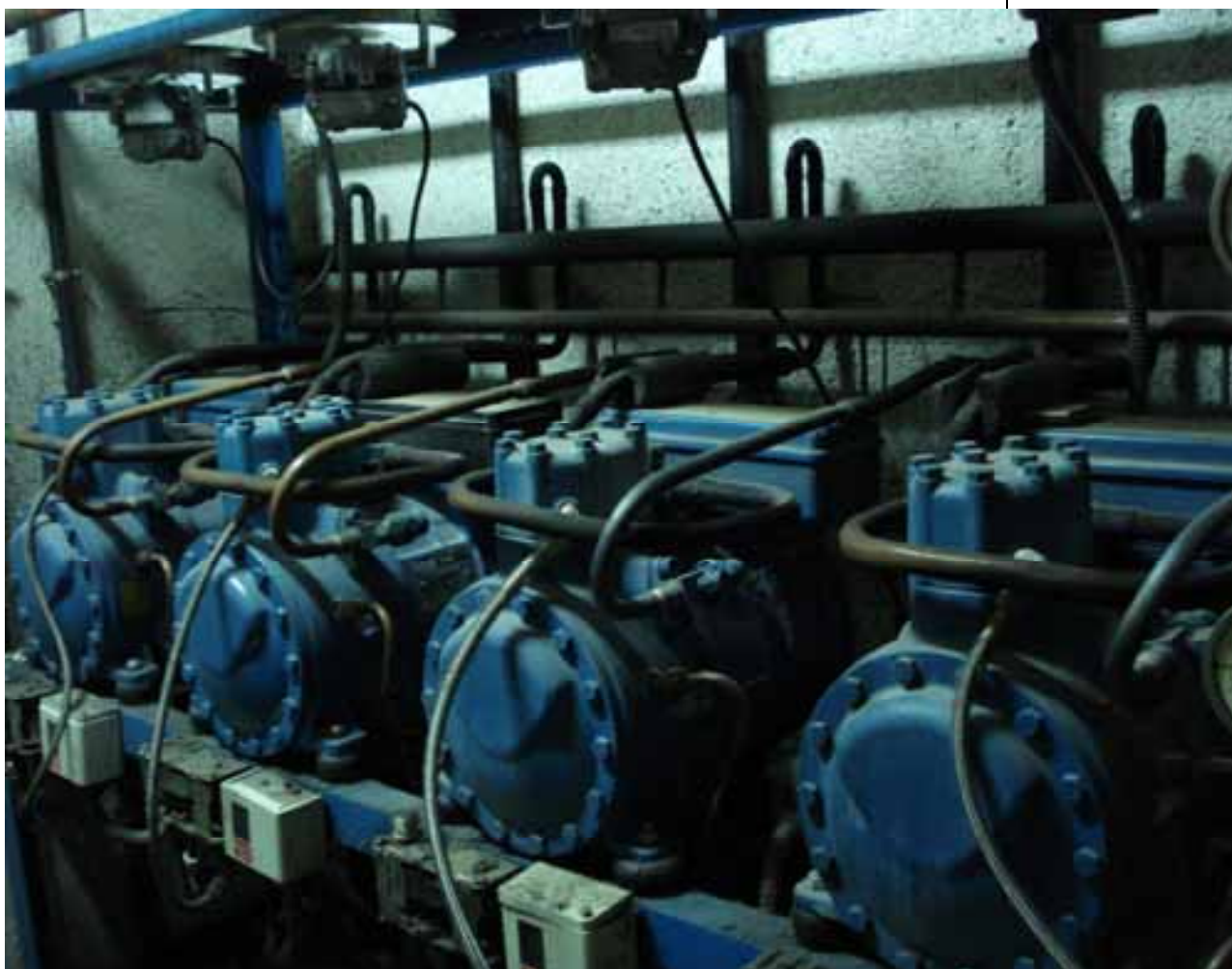
Foto 3.4. Grupo de compresores en autoservicio.
