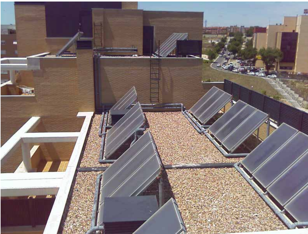
Foto A2.9. Instalación de captadores solares térmicos para producción de A.C.S. (Fuente: Ferrolí).
