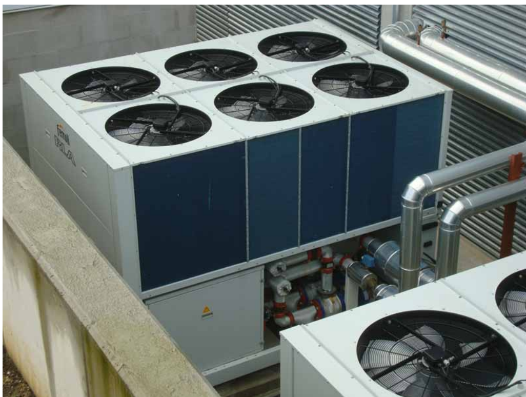
Foto A1.9. Máquinas enfriadoras (Fuente: Ferrol).
