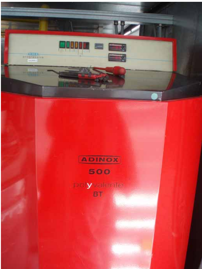
Foto A1.1. Detalle de una de las calderas instaladas en el Hotel Madrid Norte (cadena Rafael Hoteles).
