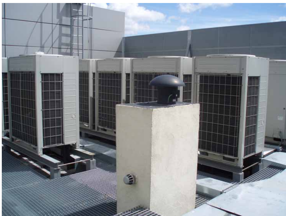
Foto A1.8. Equipos productores de frío en el Hotel Madrid Norte (cadena Rafael Hoteles).
