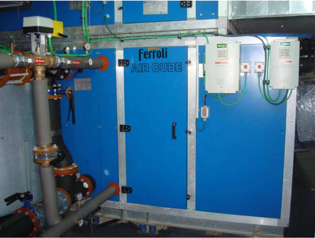
Foto A2.6. Equipo climatizador (Fuente: Ferroli).
