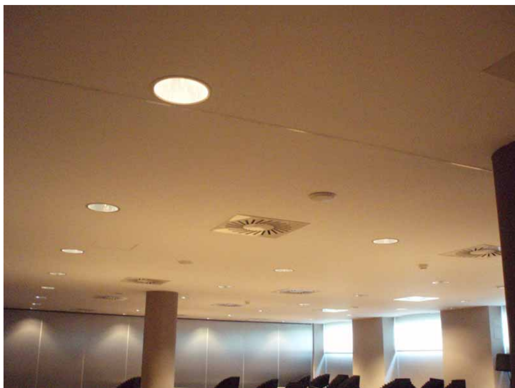
Foto 3.8. Sistema de iluminación de un salón de actos del hotel Madrid Norte (Fuente: Rafael Hoteles).
