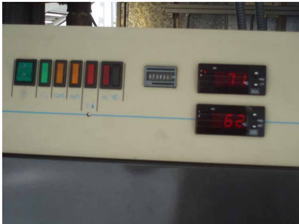
Foto A1.4. Panel de mandos de una de las calderas instaladas en el hotel Madrid Norte (cadena Rafael Hoteles).
