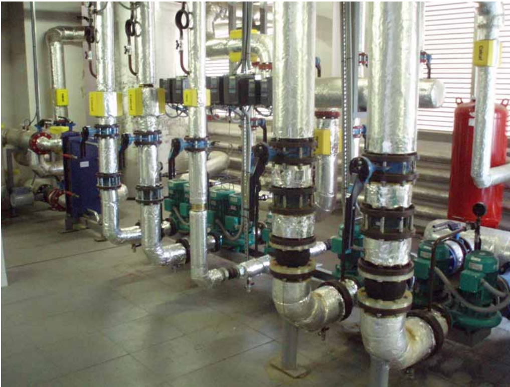
Foto 3.4. Vista general de la sala técnica hotel Madrid Norte (Fuente: Rafael Hoteles).
