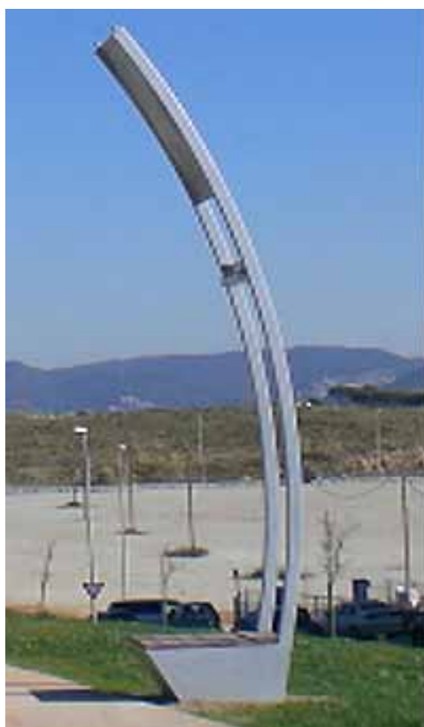
Foto 8. Farola fotovoltaica modelo Curva instalada en Ripollet del Vallés, cerca de Barcelona (Fuente: Siarq).
