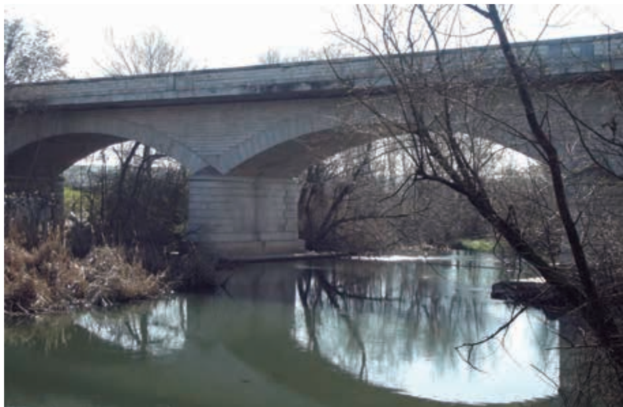
[Fig. 28] Puente de Algete sobre el río Jarama, Comunidad de Madrid, siglo XIX (22m de luz).
