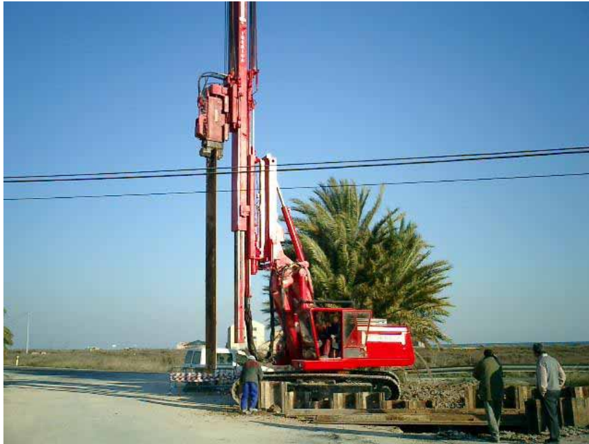
Colocación de tablestacado. Durante la fase de proyecto debe minimizarse el número de servicios afectados por las obras de tendido de la conducción
