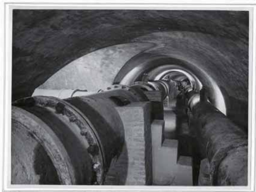
Nº 4. GALERIA Y DOS SALIDAS DEL TERCER DEPÓSITO, CON LAS TUBERIAS DE 1000 y 500 mm.
