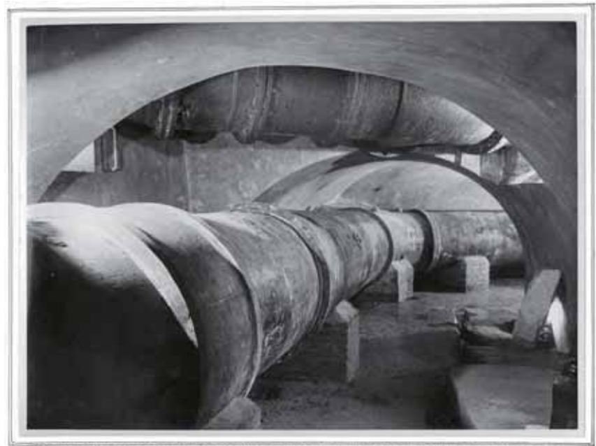
Nº 9. CRUCE DE LA TUBERÍA ENTERRADA DE SAN BERNARDO CON LA INSTALADA EN GALERÍA VICIETEMENTE, EN RODRIGUEZ SAN PEDRO Y SAN BERNARDO.
