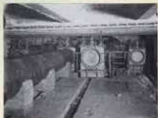
Deposito elevado - Camara de lavas
