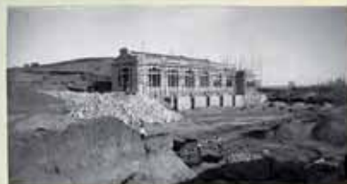
Canal Transversal. Casa de máquinas. No. 15
