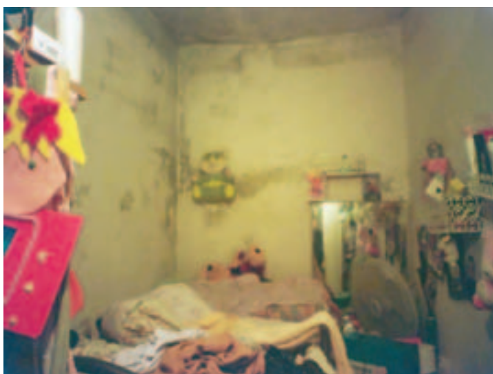
Foto 3: Detalle de habitación con presencia de humedades y mohos
