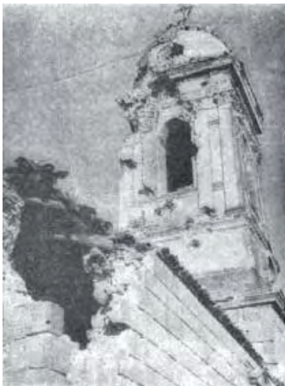
Fig. 20.- La iglesia de Brunete muestra las huellas de los impactos artilleros. Hubo de ser demolida y reconstruida completamente, modificándose su estilo de acuerdo con el nuevo aspecto urbano. Fotografía de la obra Historia de la Cruzada española .
