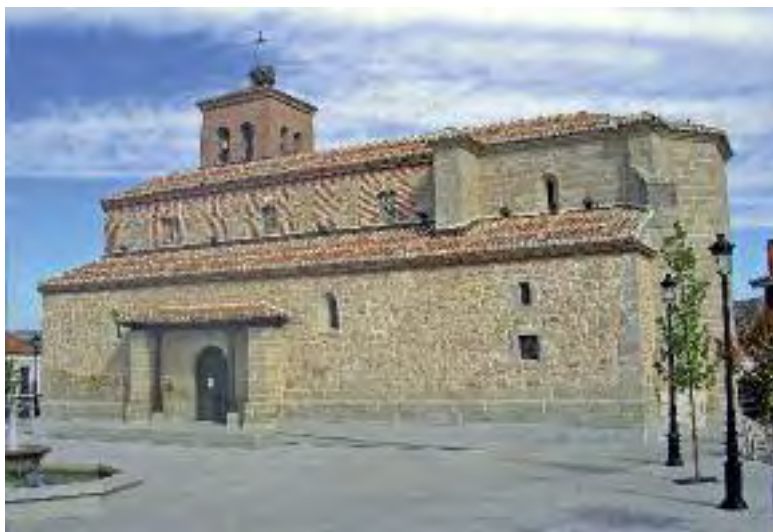
Fig. 77.- Iglesia parroquial de Quijorna. En su fábrica se aprecian impactos de metralla y balazos. Fotografía: Pablo Schnell.
