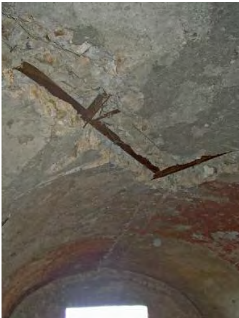
Fig. 94.- En bastantes obras el hormigón ha sido picado a mano para recuperar el hierro de su estructura. Era una manera de obtener chatarra en los difíciles años de la posguerra. En la imagen se observa la bóveda de un fortín de la que se ha intentado extraer los elementos metálicos. Fotografía: Pablo Schnell.
