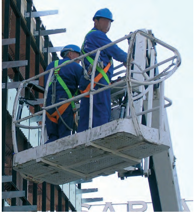
Figura 82. Trabajador con arnés en plataforma
