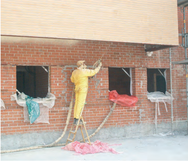
Figura 52. Aplicación de aislante (poliuretano expandido) que produce gases tóxicos.
