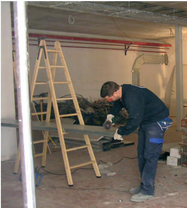
Figura 42. Utilización de radial sin protectores auditivos.
