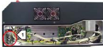
FIG. 6 Interruptor de interbloqueo del cabezal láser (parte eléctrica)
