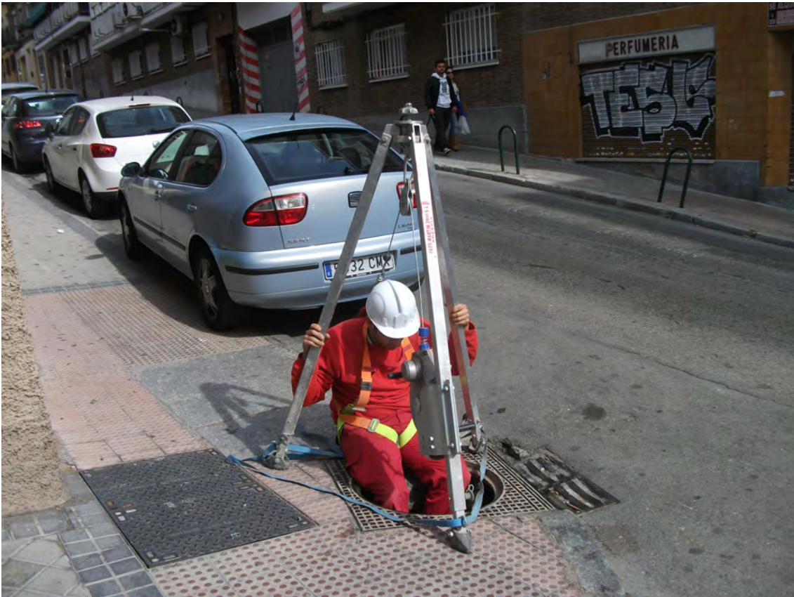
Fig. 30: Maniobra de acceso adecuada al interior de un pozo, empleando un trípode.
