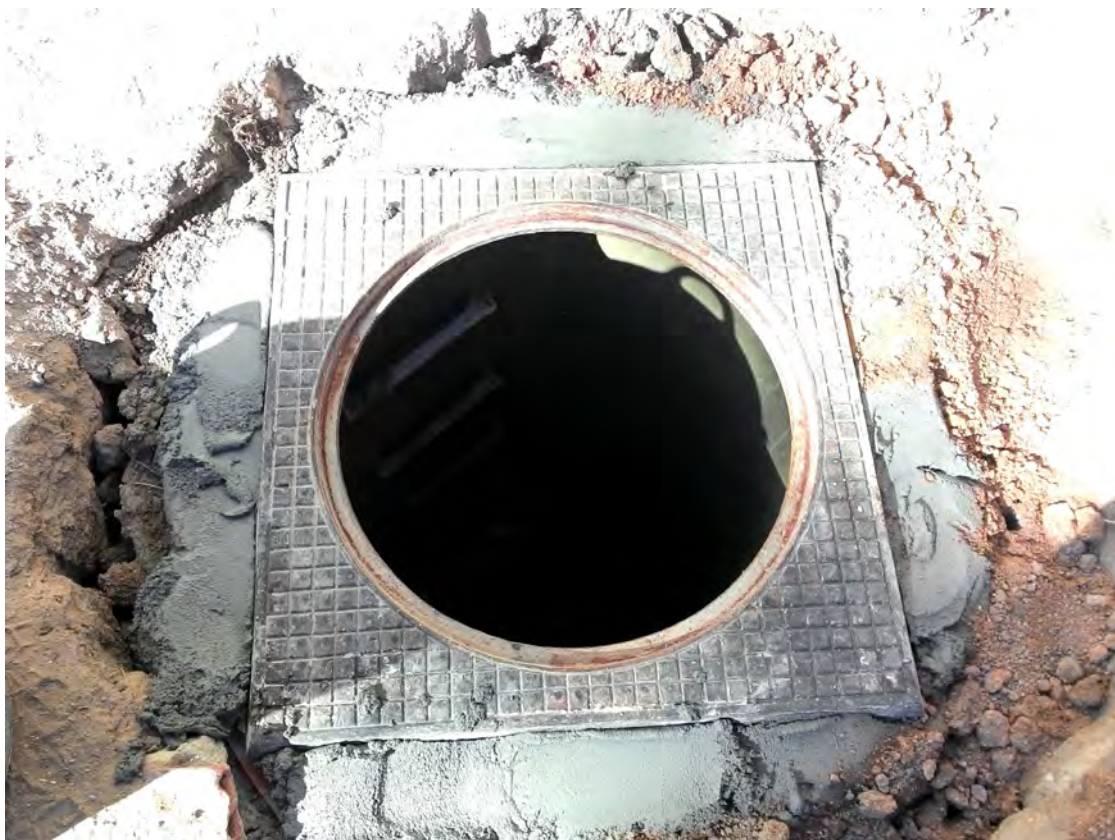
Fig. 31: Tapa dispuesta en la boca de acceso a un pozo que conduce a una galería de saneamiento.
