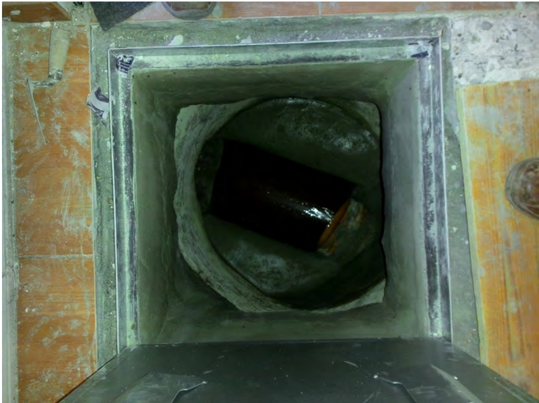
Fig. 8: Tapa abierta en una arqueta, para acceso a una conducción al objeto de realizar tareas de limpieza y desatranco.
