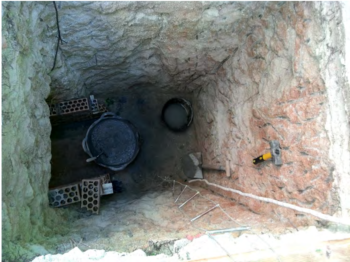
Fig. 38: "Falso pozo" realizado en una terreno de gran consistencia, para permitir el acceso a una galería en mina que se está ejecutando. Nótese el acceso a través de una escalera flexible.
