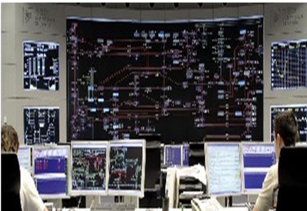
Foto 7.1. Centro de Control de REE.
