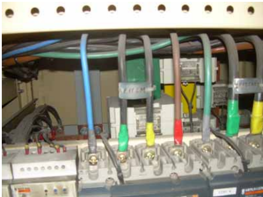
Foto 3.2. Cuadro eléctrico de acometida a transformador.
