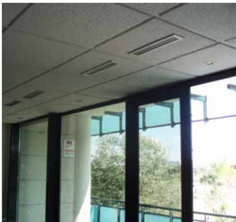
Foto A2.2. Sistema de climatización en las oficinas de Geoter (Fuente: Geoter).
