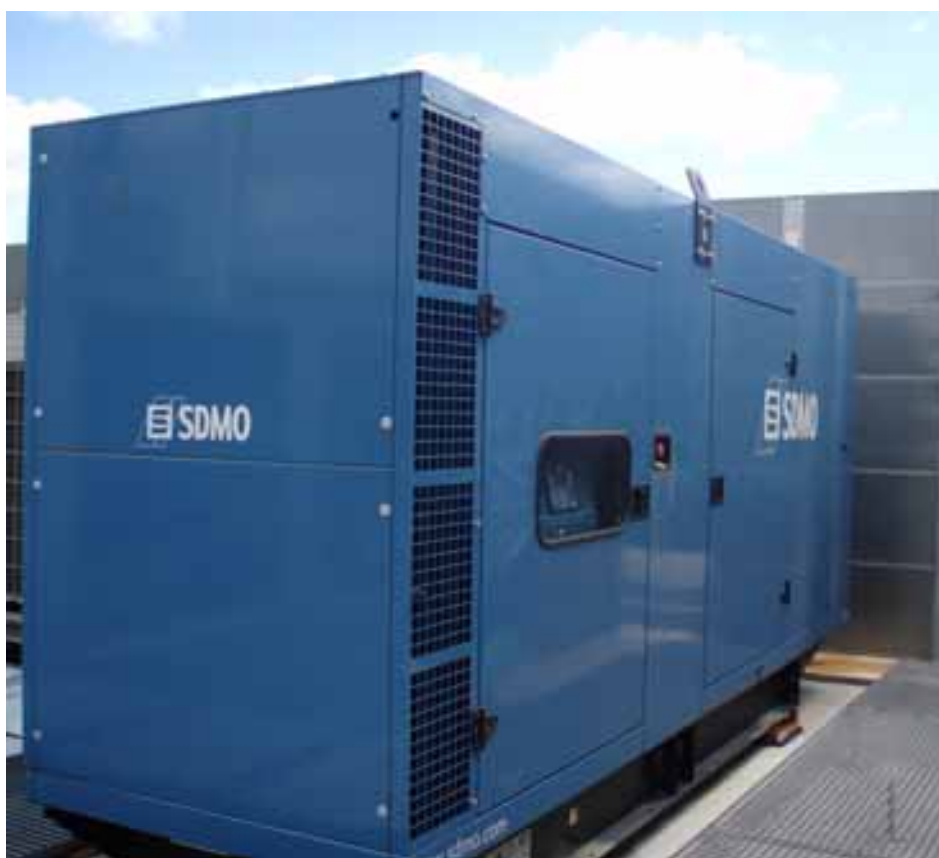
Foto A1.9. Grupo electrógeno instalado en el hotel Madrid Norte (Fuente: Rafael Hoteles).
