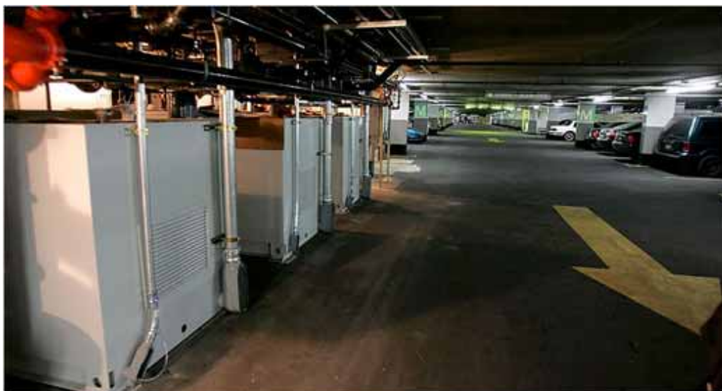
Foto A1.8. Equipos de cogeneración en un parking de un edificio de oficinas en Manhattan (Fuente: Earthfirst).
