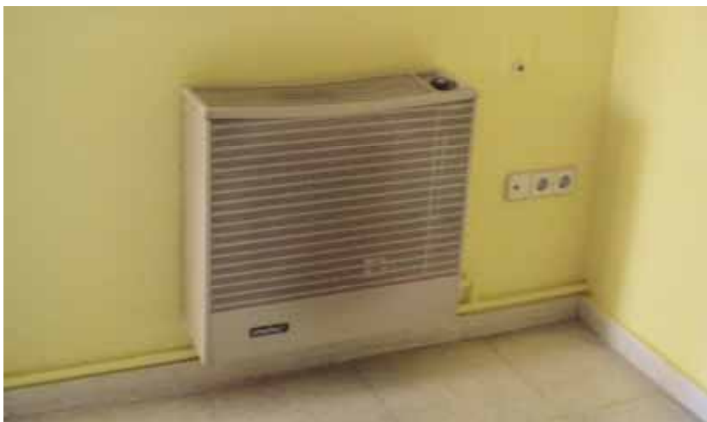
Foto 1.4. Aparato de calefacción obsoleto a sustituir.
