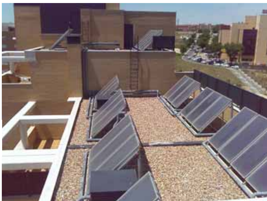
Foto A1.10. Grupo de paneles solares instalados en la cubierta de un edificio en Madrid (Fuente: Ferroli) .
