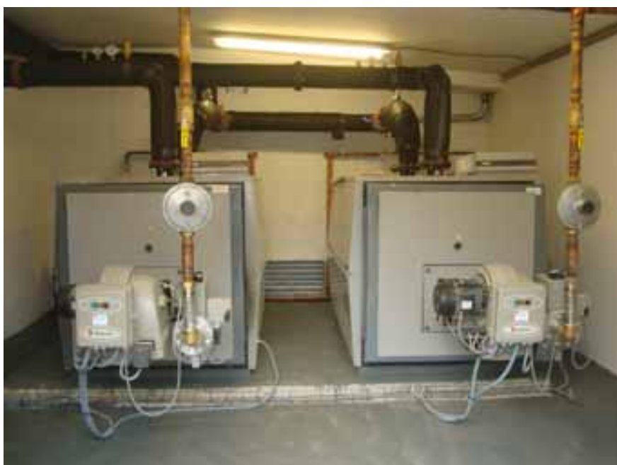
Foto A1.1. Calderas en edificio de oficinas (Fuente: Ferrol).
