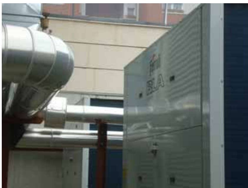
Foto A2.6. Enfriadora instalada en edificio terciario (Fuente: Ferroli).
