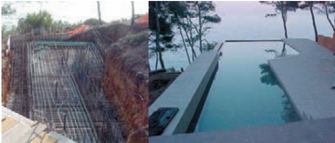
Figura 11. Ejemplo de integración en la edificación: intercambiador de calor horizontal enterrado bajo una piscina. (Fuente: Instalaciones TONVA, S. L.).
