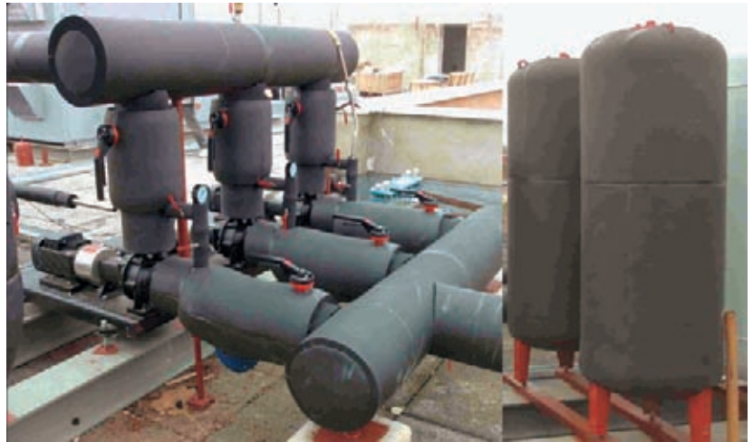
Figura 8. Planchas de aislamiento en tuberías y tanques.
