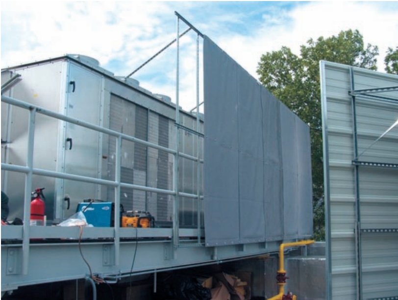
Foto 4.1. Colocación de pantallas para la atenuación de unidades exteriores en instalaciones de climatización
