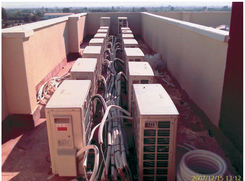
Foto 3.4. Apantallamiento sonoro de los equipos exteriores empleando la propia azotea.
