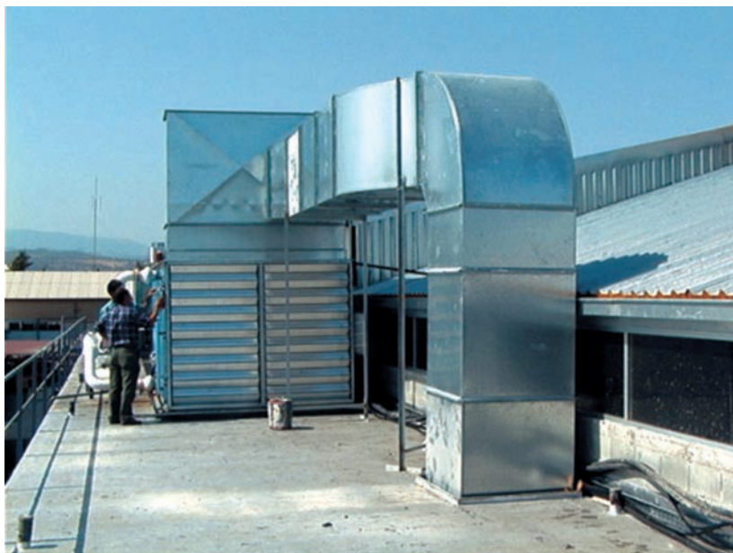
Foto 3.2. Unidad exterior en cubierta con silenciador en la toma de aire.
