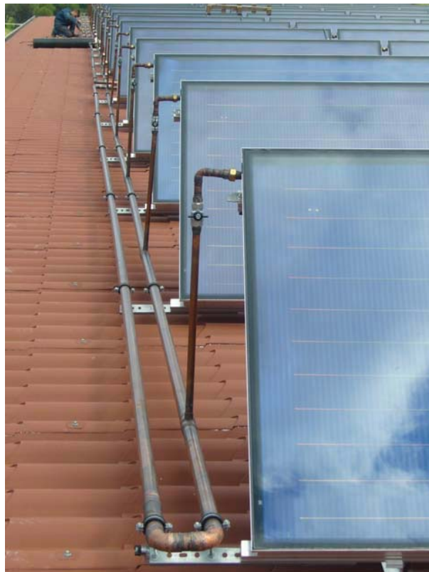
Foto A1.10. Ejemplo de instalación solar térmica. (Fuente: Ferroli).
