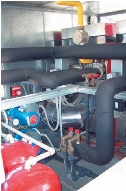
Foto 3.2. Vista de detalle de la instalación térmica del Centro Comercial ParqueSur.
