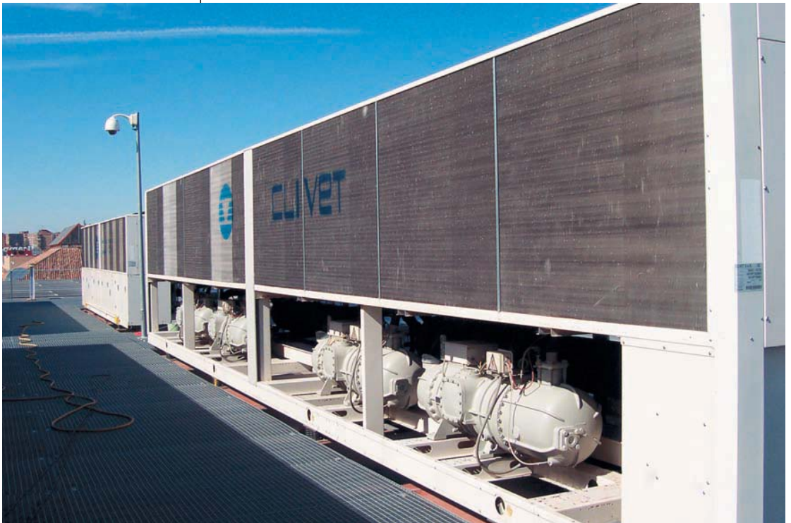
Foto A2.4. Enfriadora instalada en el Centro Comercial ParqueSur.
