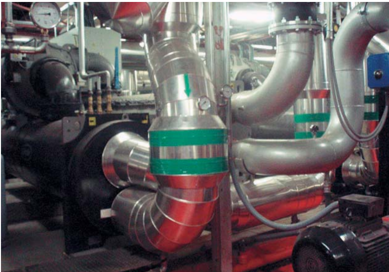
Foto 3.6. Detalle de sala técnica con equipos generadores de frío en el Centro Comercial La Vaguada.
