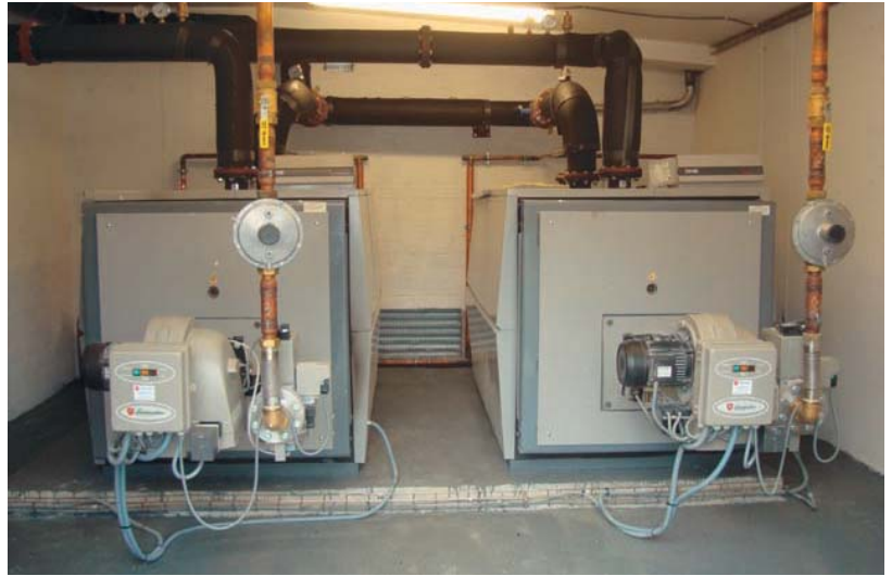
Foto A1.1. Grupo de calderas para altas potencias. (Fuente: Ferrol).
