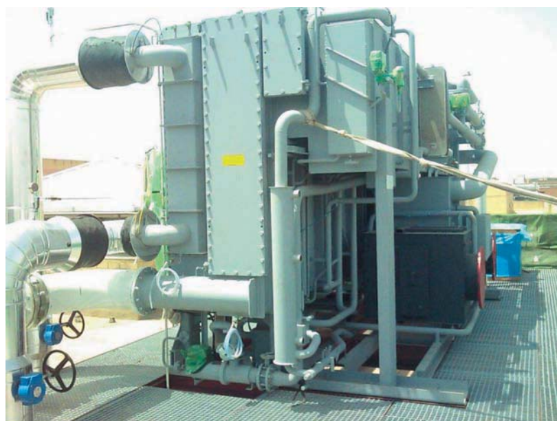
Foto A1.8. Ejemplo de cogeneración en Centro Comercial.
