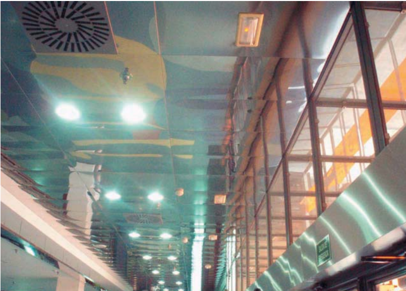
Foto A2.8. Sistema de distribución térmica y sistema de iluminación en el Centro Comercial Equinoccio.
