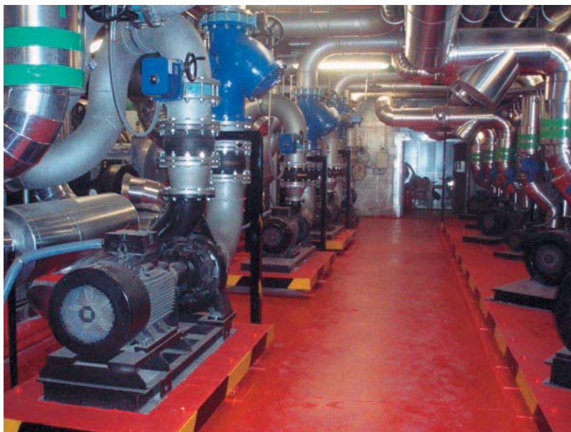
Foto A1.7. Grupos frigoríficos instalados en el Centro Comercial La Vaguada.
