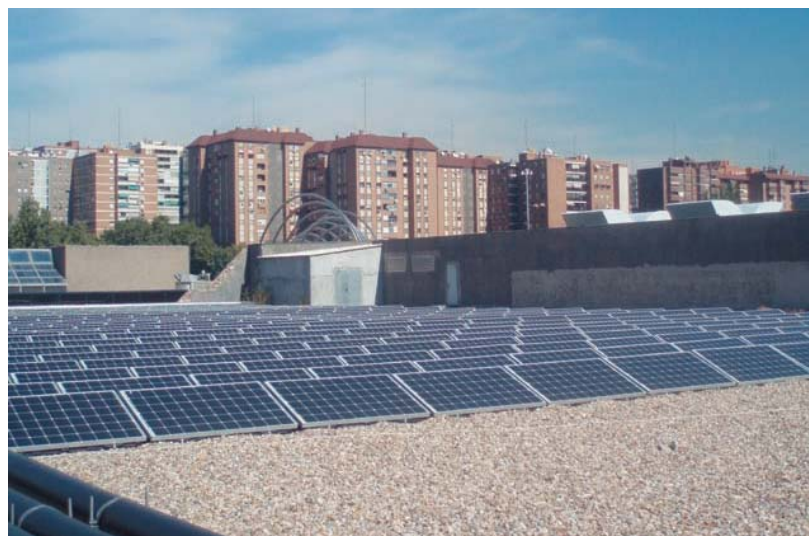
Foto A1.11. Instalación fotovoltaica en el Centro Comercial La Vaguada.
