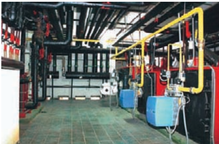
Foto 9. Sala de calderas.
