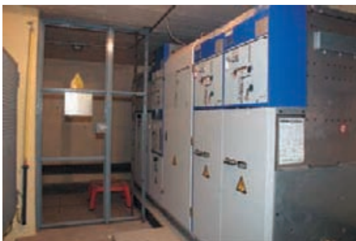
Foto 6. Control de regulación eléctrica.
