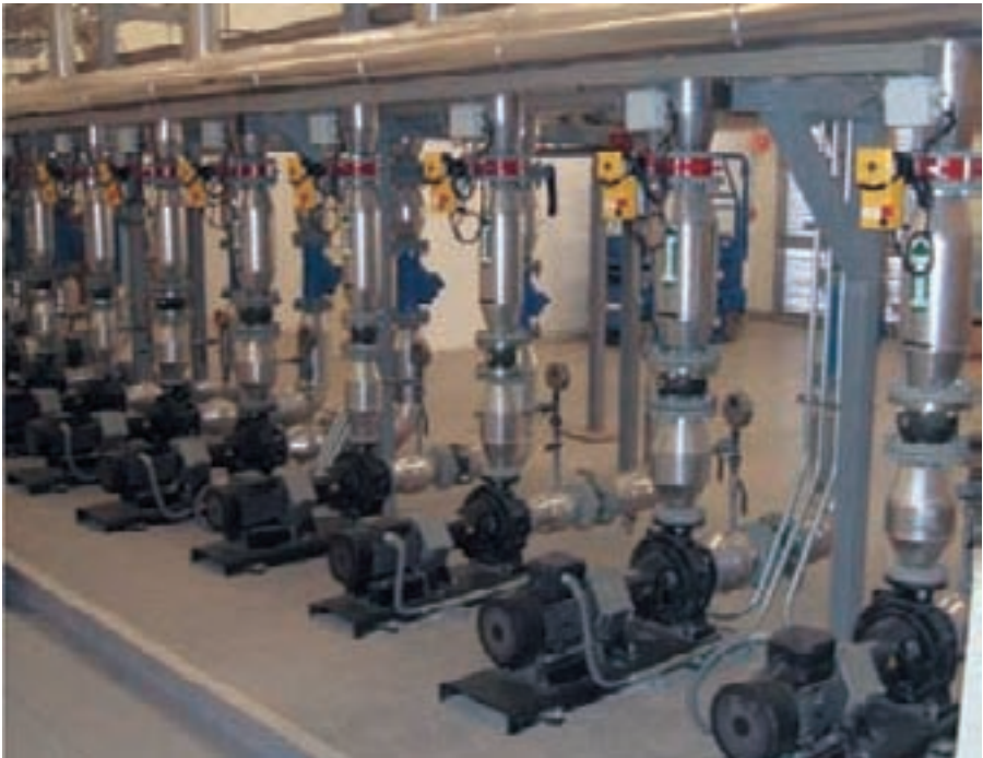
Foto 1. Estación de bombeo.
