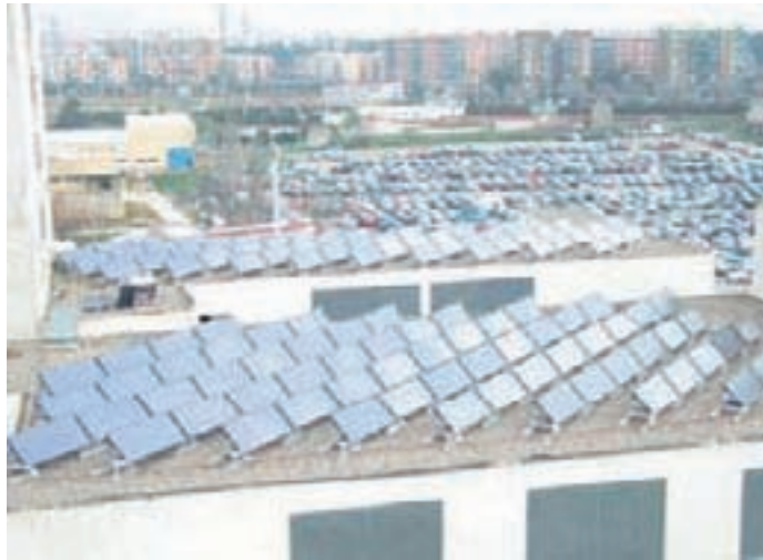
Foto 1. Central de producción de energía solar térmica.
