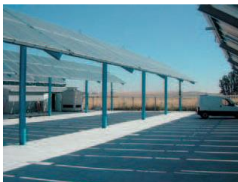
Foto 1. Distribución de paneles solares. Fuente: Absorsistem.
