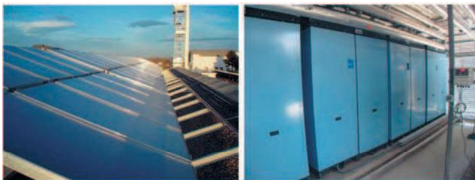
Fotos 3 y 4. Campo de captación solar (izq.) y bombas de calor por absorción (dcha.).
