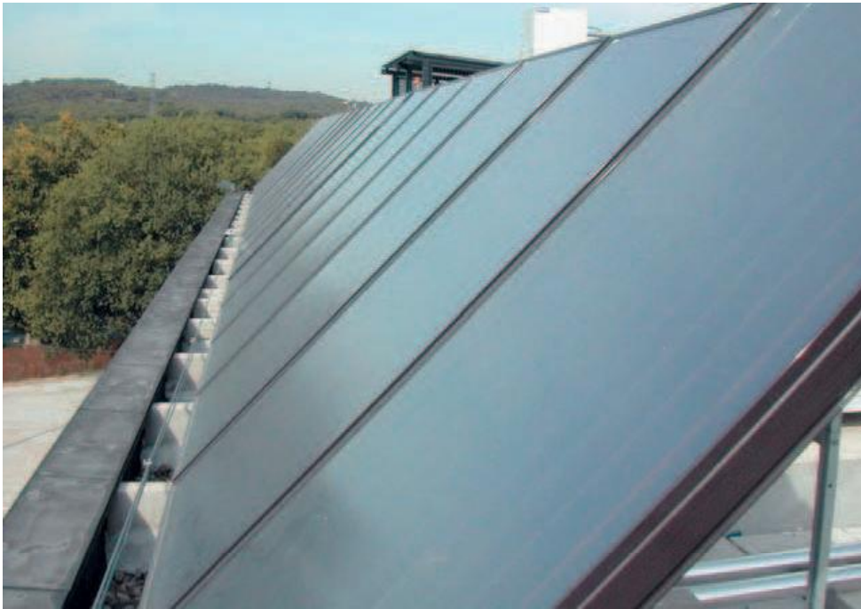
Foto 3. Campo de captadores solares térmicos.
