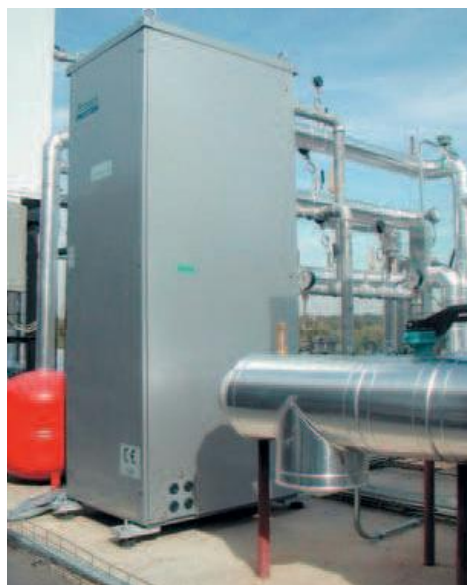
Foto 2. Planta enfriadora de agua por ciclo de absorción YAZAKI modelo WFC SC05.
