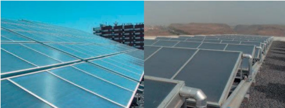
Foto 3. Colectores solares de alto rendimiento. Fuente: Absorsistem.
