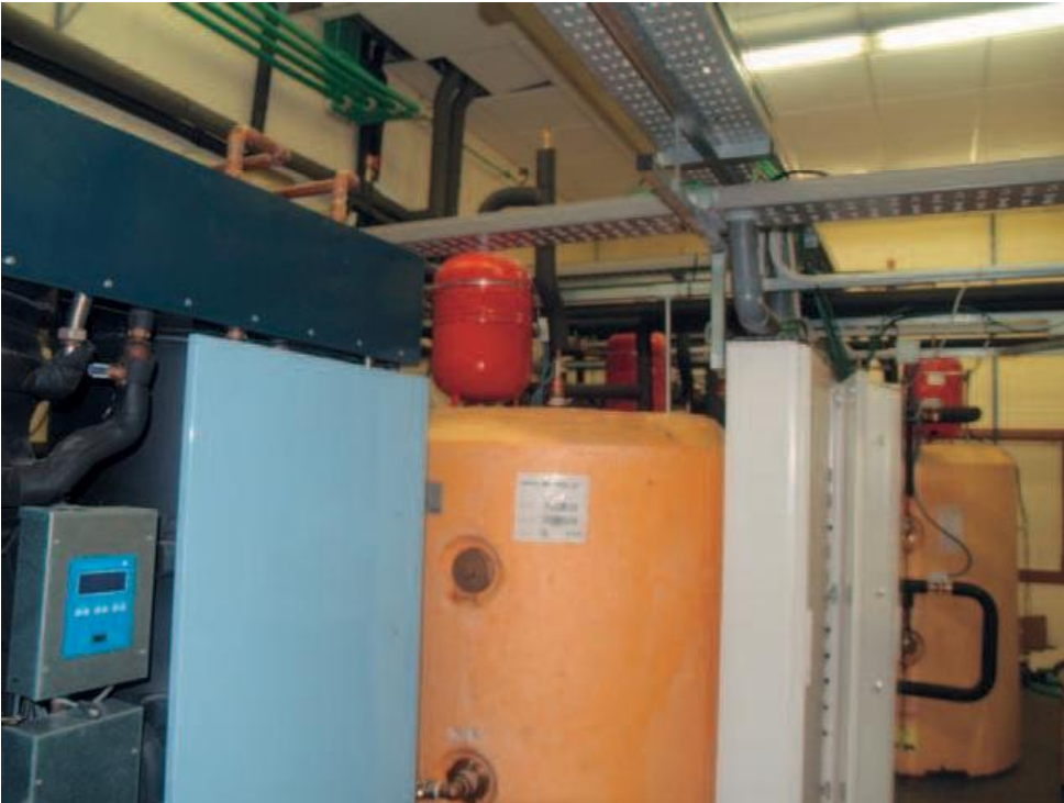
Foto 2. Sala de máquinas del BPFSG. Fuente: ARFRISOL.
