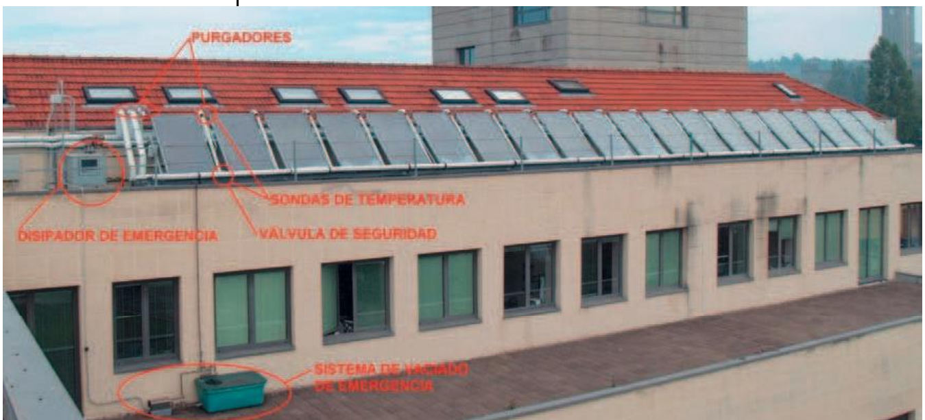
Foto 1. Campo de captadores solares de la instalación. Fuente: ARFRISOL.
