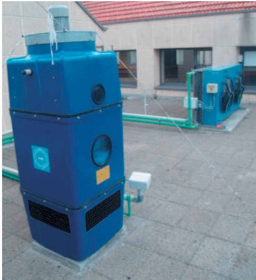
Foto 3. Sistemas de disipación. Fuente:ARFRISOL.
