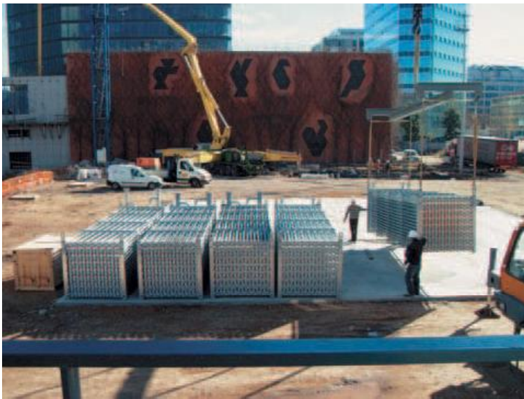
Figura 11. Descarga de baterías de hielo en la Central Tánger de Districlima (Barcelona).
