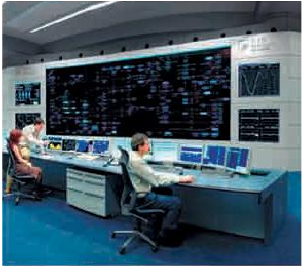
Figura 2. CECOEL (Centro de Control Eléctrico). Fuente: REE.
