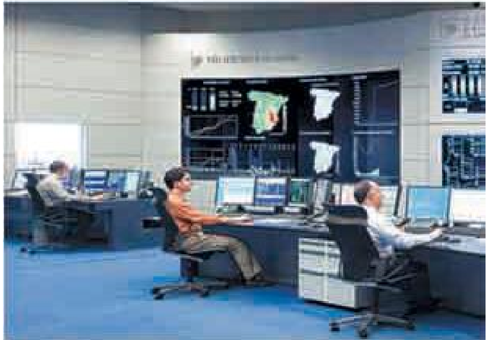
Figura 6. CECRE (Centro de Control de Energías Renovables) y CECOEL. Fuente: REE.
