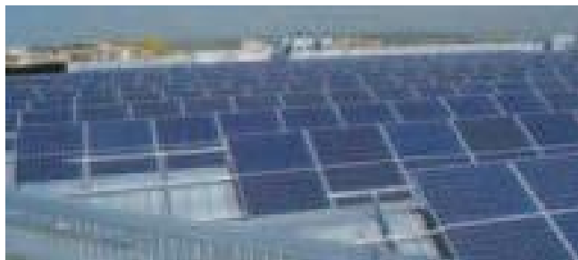
Vista de los paneles fotovoltaicos en cubierta
