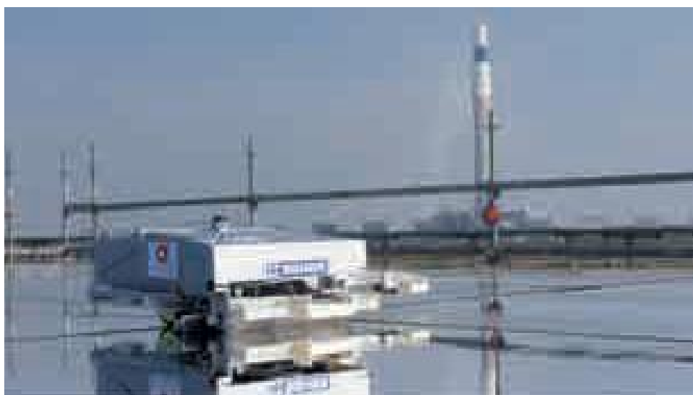
Foto 15. Robot del sistema HECTOR en operación en pruebas en la planta Gemasolar.
