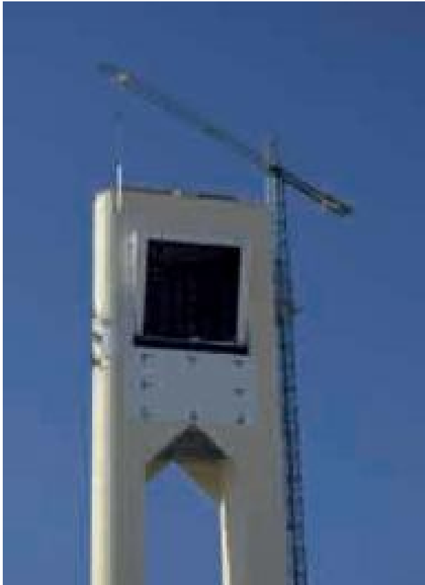
Foto 17. Trabajos de colocación por parte de los escaladores de las protecciones térmicas del fuste de la torre a la altura del receptor solar.
