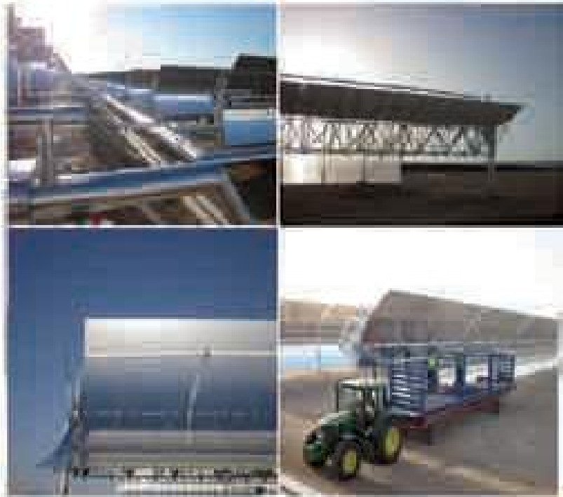
Foto 2. Tuberías y juntas rotativas, estructura captador, espejos y receptores de las CST. Fuente: Astexol 2, 2011.
