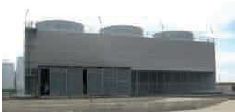
Foto 5. Torre de refrigeración. Fuente: Archivo RENOVETEC.
