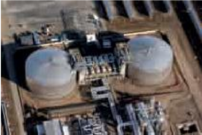
Foto 6. Sistema de almacenamiento térmico en una central CCP en construcción. Fuente: Archivo RENOVETEC.
