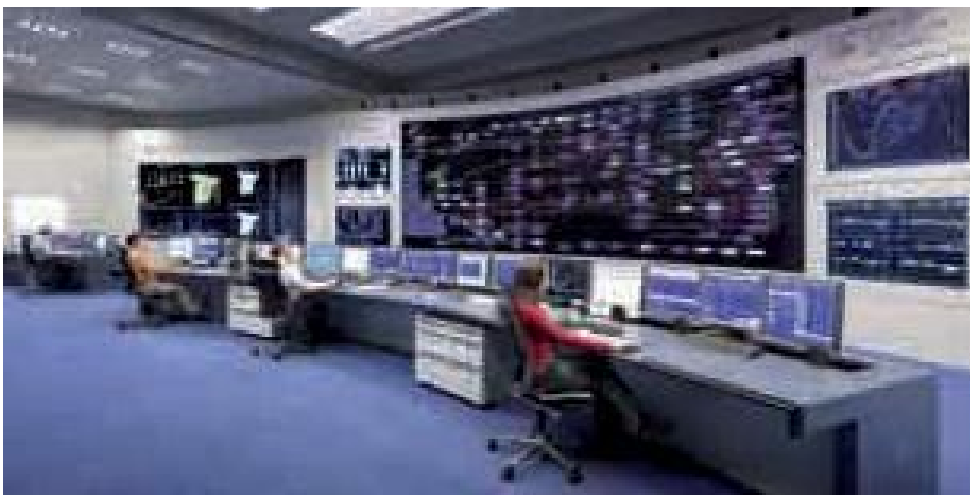
Foto 1. Centro de Control Eléctrico (CECOEL) de Red Eléctrica de España. Fuente: www.ree.es
