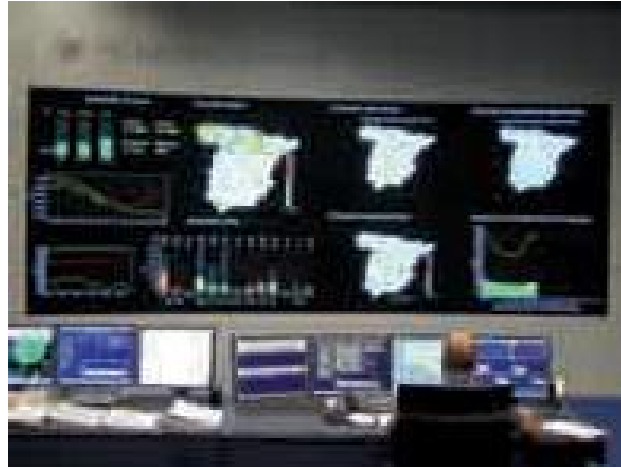
Foto 3. Centro de Control Eléctrico de Régimen Especial (CECRE) de Red Eléctrica de España. Fuente: REE.
