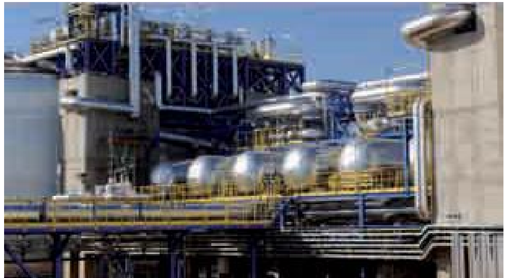
Foto1. Intercambiadores en la planta Andasol I.
