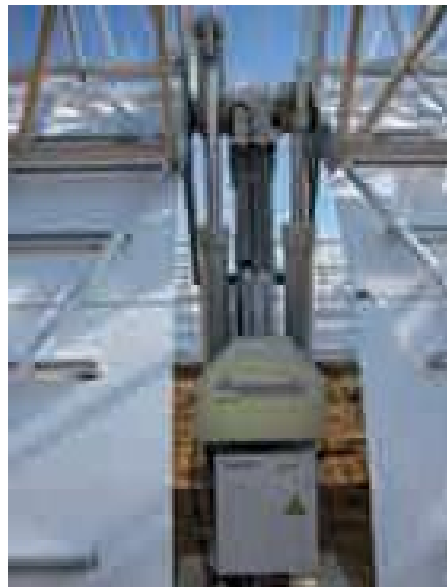
Foto 6. Detalle de DrivePylon montado por Acciona en Palma del Río I. Fuente: Acciona Energía.
