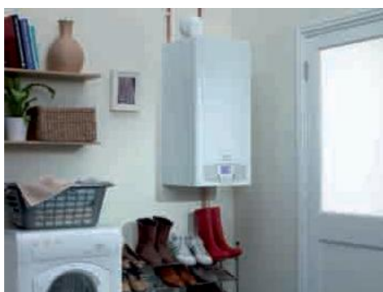
Foto 12. Disposición de un equipo motor Stirling en una vivienda (Baxi-roca).
