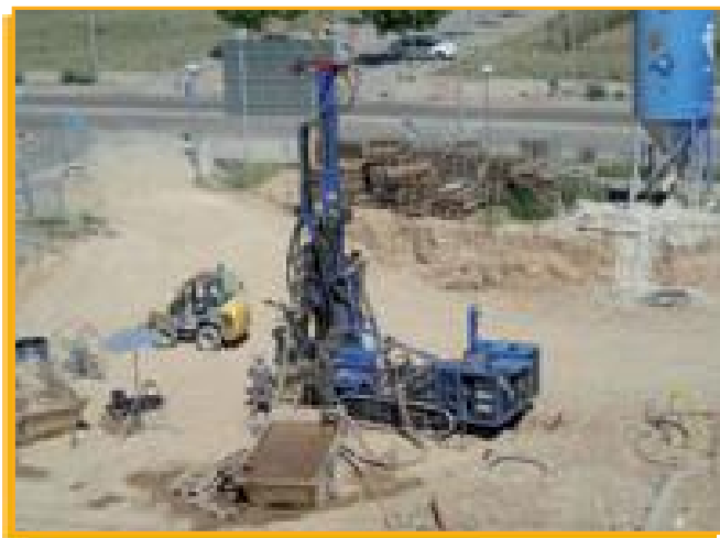
Sistema geotérmico de alta eficiencia energética en el nuevo Edificio Polivalente de la Universidad de Alcalá de Henares
